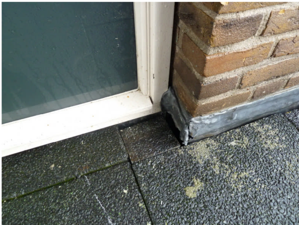
Foto 4.151: Visuele opname dak platform – lood is slordig aangebracht.
