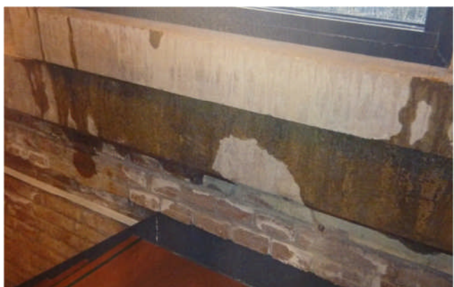
Foto 2.16: Lekkages 23-10-2010 – betonnen kaders, aansluiting kozijn en doorslag door gevel.
