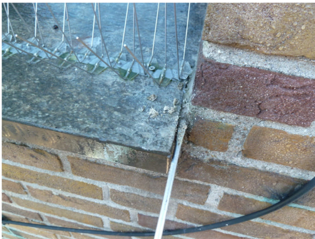
Foto 4.88: Noordgevel: voeg tussen leisteek afdekker en gevel 'verpulpt'.
