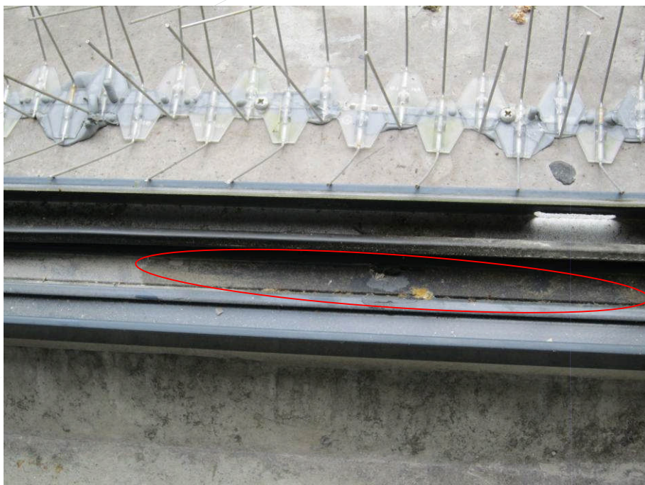
Foto 3 Water achter de middendichting.
