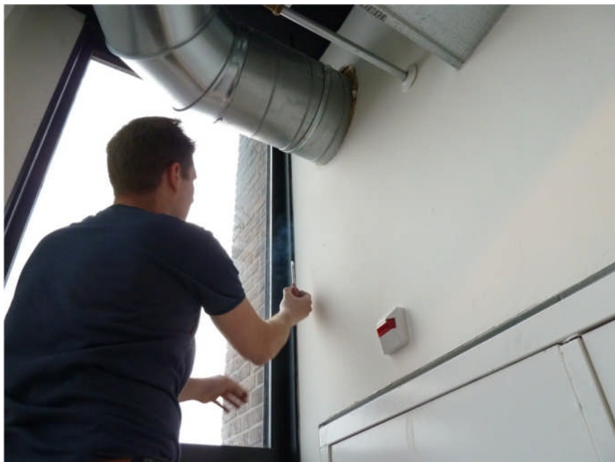
Foto 4.33: 7 e verdieping – met rook is beoordeeld waar luchtlekken aanwezig zijn. De bouwkundige aansluitingen van de kozijnen op het kader zijn op diverse plekken niet luchtdicht.
