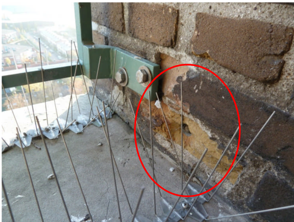
Foto 4.169: 12 e verdieping (ter plaatse van ramen lifthal) – metselwerk afgeschilferd. Oude (?) bevestigingen van het hekwerk zijn zichtbaar verroest.
