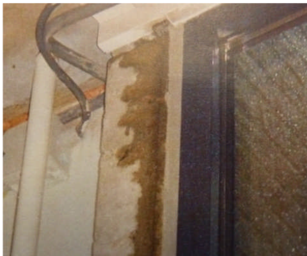
Foto 2.11: Lekkages 12-11-2010 – betonnen kaders en doorslag door gevel.
