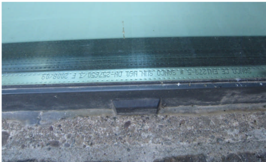
Foto 4.72: Begane grond - de aluminium kozijnen in de gevel zijn op veel plaatsen vrij laag geplaatst. Ontwatering van het kozijnsysteem kan zo niet goed plaatsvinden omdat het ontwateringskapje vrijwel op de ondergrond rust.
