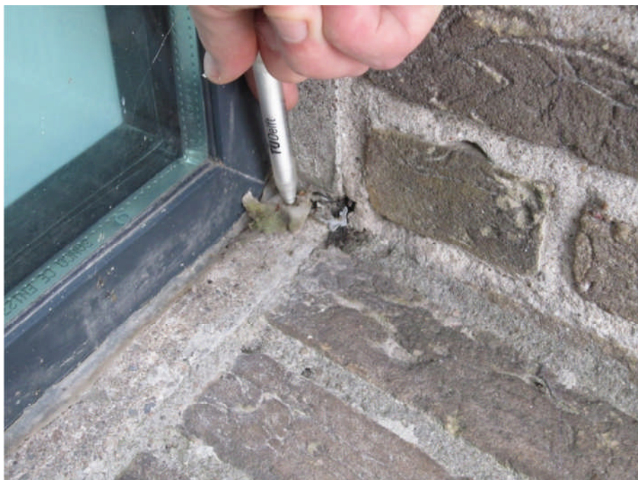
Foto 4.76: Kitdichting heeft zo geen nut. 'Open' verbinding tussen buiten en 'spouw', t.p.v. het betonnen kader rondom het raam – zie ook volgende foto.
