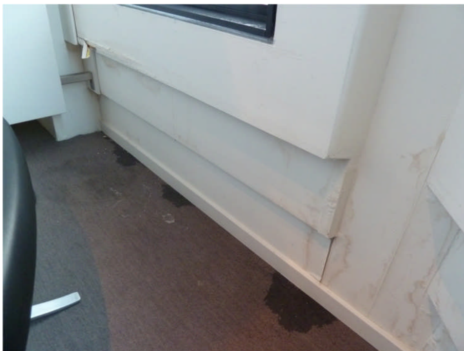
Foto 4.54: Sproeitest 7 e verdieping (restaurant) – overzicht lekkages na sproeitest (zie natte vlekken vloer).
