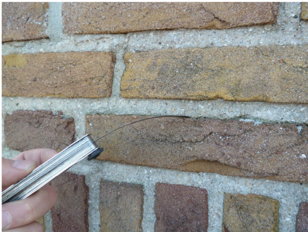
Foto 4.95: Noordgevel: op een enkele plaats zijn kleine scheuren (onthechting van voeg en/of mortel) aanwezig. Deze scheurtjes hebben een maat van circa 0,3 mm.
