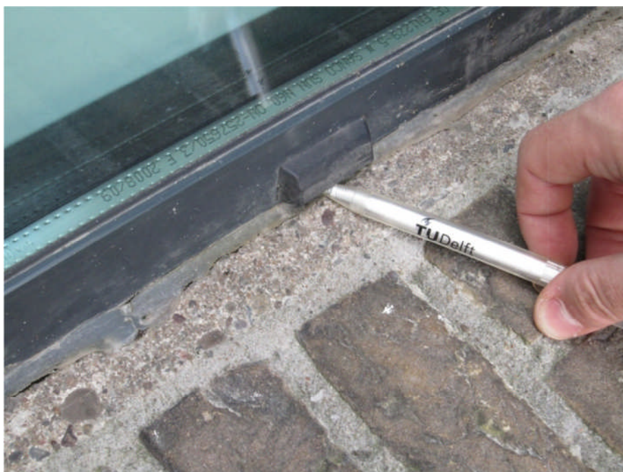
Foto 4.73: Begane grond - ontwatering van het kozijnsysteem erg laag. Kit ter plaatse van onderdorpel hecht niet (meer).
