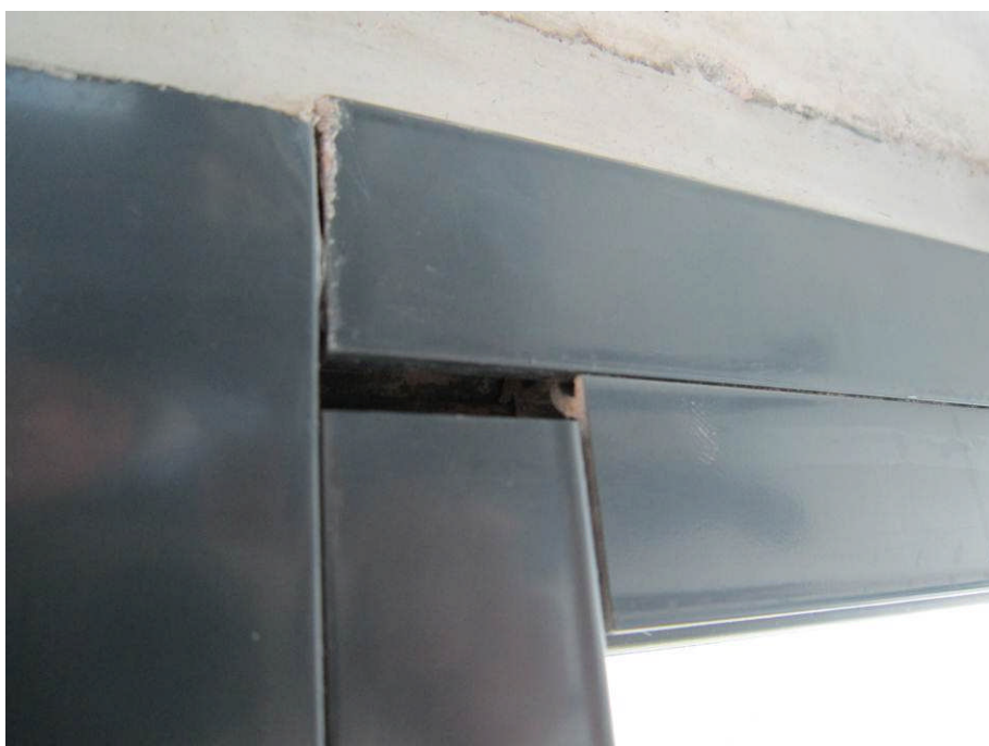
Foto 4 Slechte aansluiting van glaslatten onderling.
