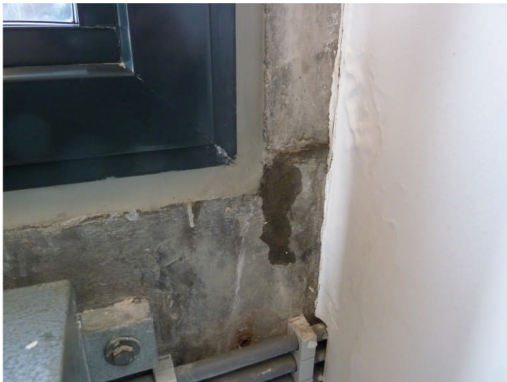
Figuur 4.58: Positie sproeitest 8 e verdieping (overloop, rechter raam) –lekkages betonnen kader na enkele minuten.
