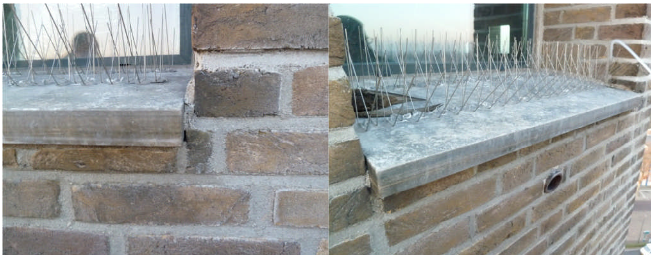
Foto 4.127a en -b: Zuidoostgevel (ter hoogte van 11 e verd.): Aansluiting vensterbanken op gevel is niet waterdicht (voeg komt eruit).
