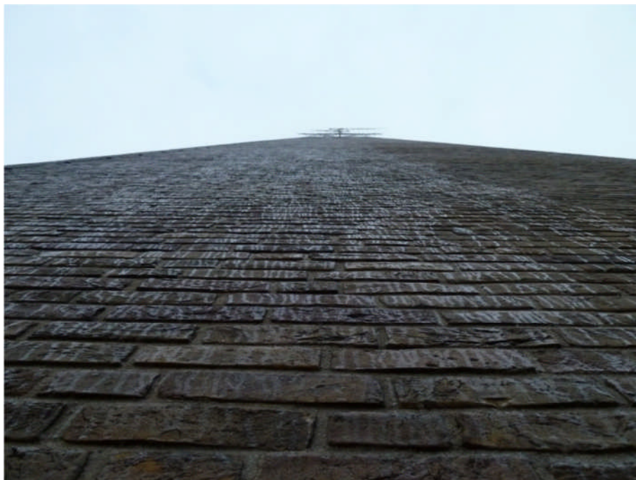
Foto 4.70: Het condensaat (gehele gevel is nat), als gevolg van nachtelijke onderkoeling, is als een 'film van waterparels/-stroompjes' op de gevel zichtbaar.
