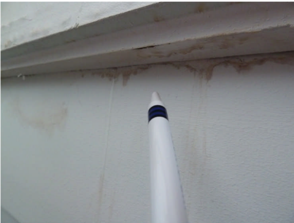
Foto 4.52: Sproeitest 7 e verdieping (restaurant) – lekkage binnen enkele minuten onder het raam – bouwkundig kader. Ook veel oude (verkleurde) lekkagesporen zichtbaar.
