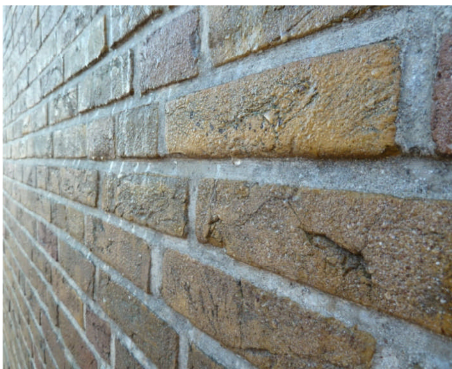
Foto 4.71: Het condensaat (gehele gevel is nat), als gevolg van nachtelijke onderkoeling, is als een 'film van waterparels/-stroompjes' op de gevel zichtbaar.
