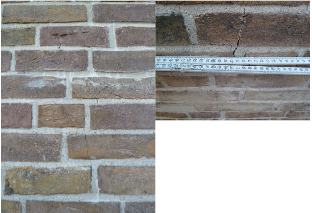
Foto 4.123a en -b: Zuidoostgevel: Scheurvorming ter hoogte van 5 e verd. vloer – scheurwijdte van < 0,1 mm – 2 mm.
