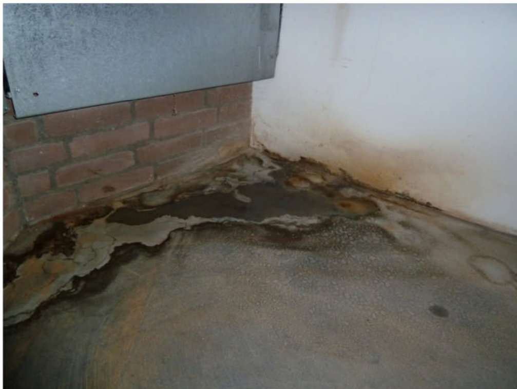
Foto 4.9: Leksporen op de vloer – onder het dak.
