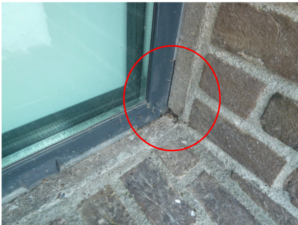
Foto 4.77: Het betonnen kader rondom het raam staat in de hoeken open (zie ook vorige foto).
