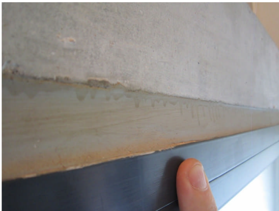
Foto 4.4: Leksporen ter plaatse van aansluiting kitvoeg op betonnen kader (bovendorpel).
