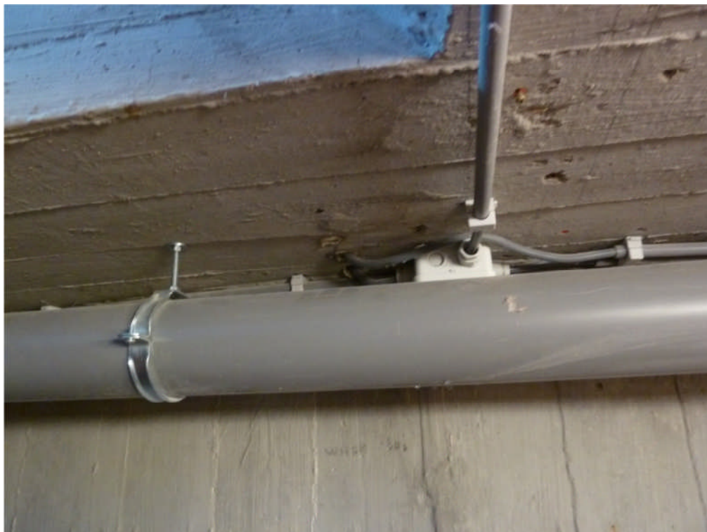
Foto 4.145: Sproeitest platform – tijdens het besproeien van de (binnen)gevel van de opbouw op het platform (zie voorgaande foto) ontstaat al snel een lekkage bij de elektradoos in het plafond (waarschijnlijk is een kabeldoorvoer niet goed gedicht).
