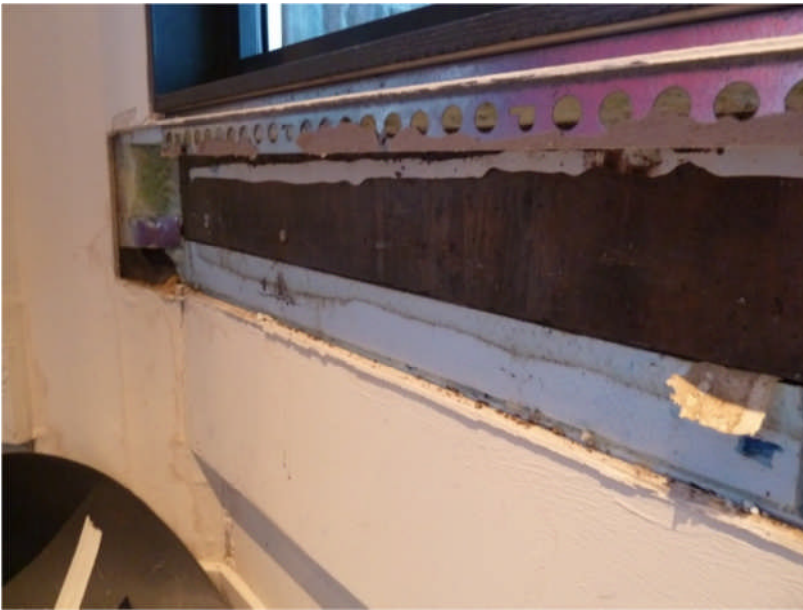
Foto 4.42: Op de 7 e verdieping is ter plaatse van een kozijn de afwerking verwijderd. Zichtbaar is dat het beton zeer nat (klam) is.
