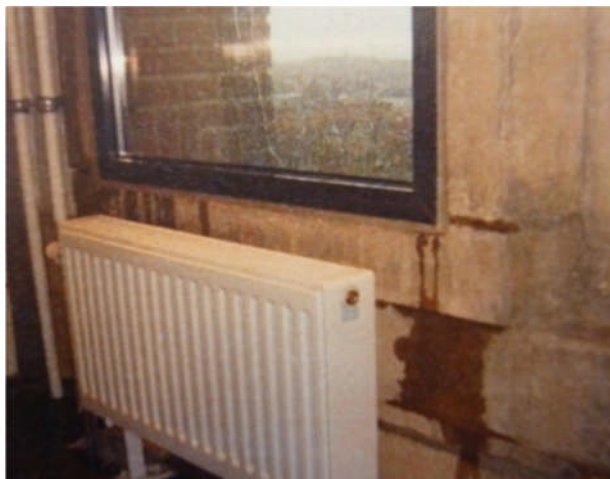
Foto 2.12: Lekkages 12-11-2010 – betonnen kaders en aansluiting kozijn.
