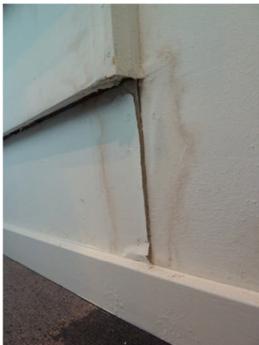
Foto 4.53: Sproeitest 7 e verdieping (restaurant) – lekkage binnen enkele minuten onder het raam – bouwkundig kader.
