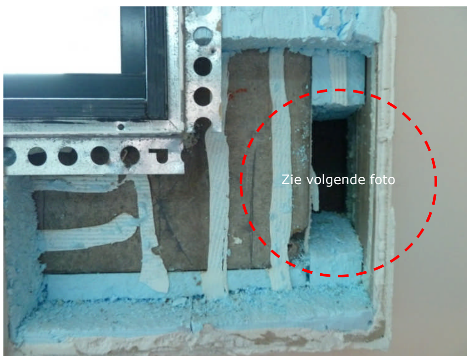
Foto 4.48: Ook hier is de betonconstructie rondom zorgvuldig met XPS geïsoleerd. Het beton is hier niet nat.
