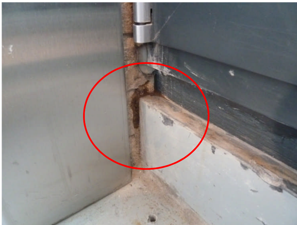
Foto 4.61: Sproeitest 12 e verdieping lifthal - lekkage ter plaatse bouwkundige aansluiting kozijn (linker raam).
