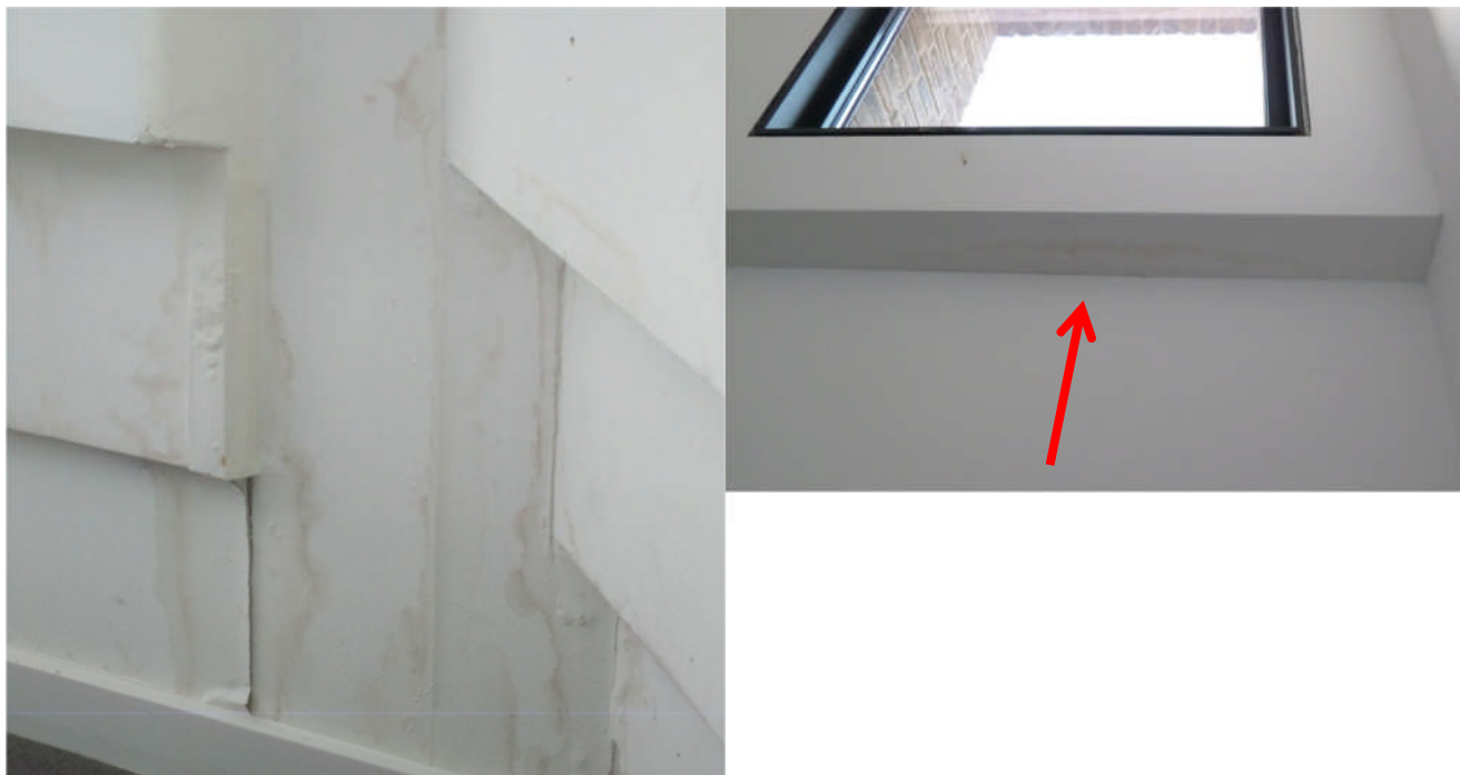
Foto 4.7: Leksporen ter plaatse van de gipsafwerking onder de ramen – 7 e verdieping (links) en 10 e verdieping (rechts).
