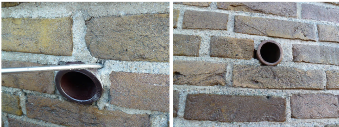
Foto 4.108a en -b: Noordwestgevel (ter hoogte van het platform): voegwerk rondom drainagebuizen is op een aantal plaatsen slecht.
