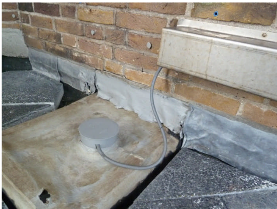
Foto 4.156: Visuele opname dak platform – lood verkeert in slechte staat. Is niet vrijgehouden van watervoerend vlak (dus capillair vochttransport). Lood heeft onvoldoende overlap (in lengterichting).
