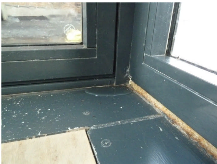
Foto 4.142: Sproeitest platform – binnen een minuut lekkage t.p.v. de aansluiting van de deur op de onderdorpel.
