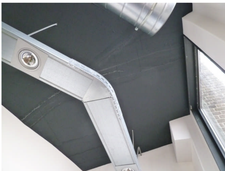
Foto 4.14: Leksporen ter plaatse van het plafond – 7 e verdieping. Ook oude lekkagesporen waargenomen op elektragoot.
