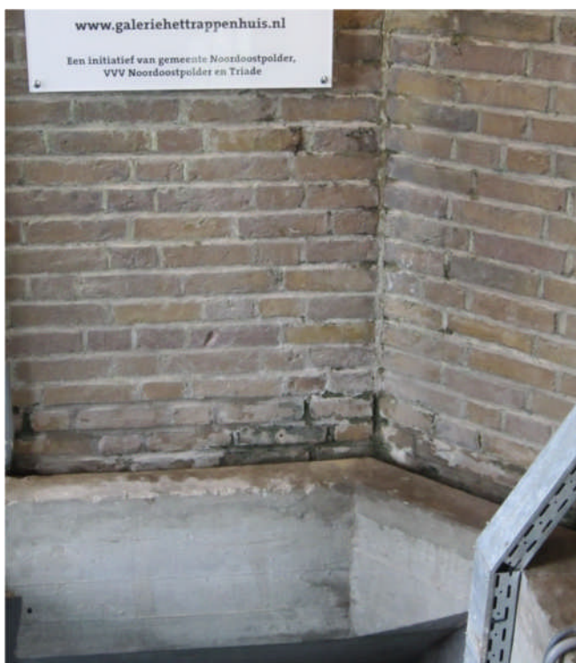
Foto 4.1: Vochtdoorslag gevel 12 e verdieping.
