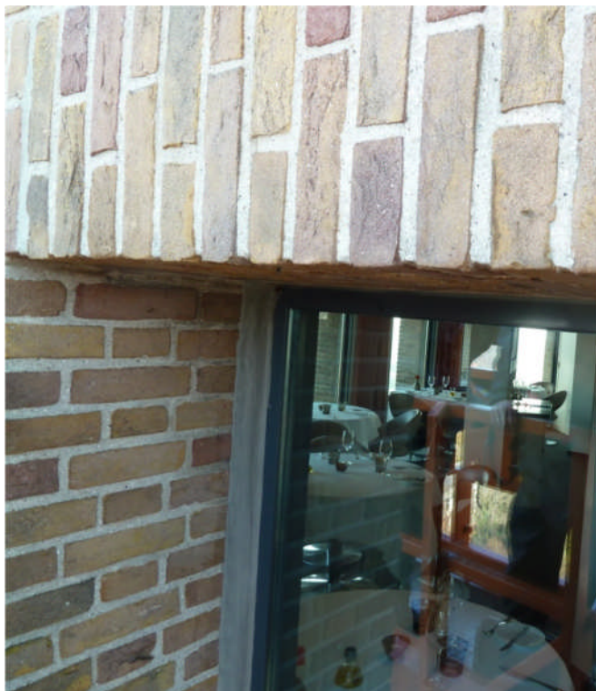
Foto 4.93: Noordgevel: de rollaag boven het kozijn watert iets naar binnen toe af.
