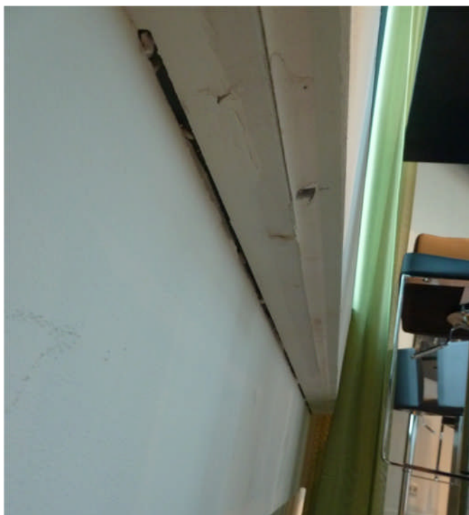
Foto 4.36: 7 e verdieping – ook onder het betonnen kader (dat hier is afgewerkt met een gipsplaat) zijn luchtlekken aanwezig.
