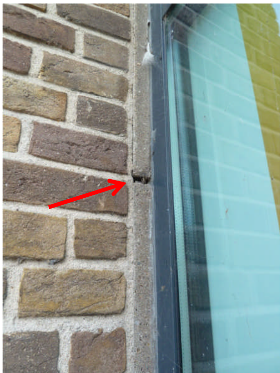
Foto 4.78: Ook in de verticale delen van het betonnen kader zijn openingen (stuiknaden) aanwezig.
