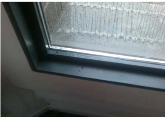
Foto 2.3: Lekkages 6 oktober 2011 – kozijnen.
