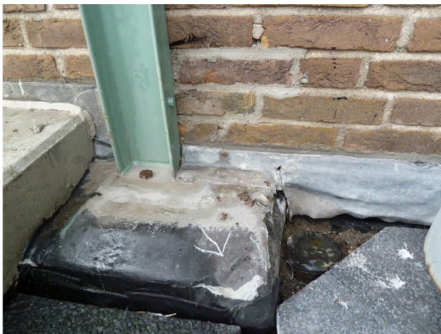
Foto 4.154: Visuele opname dak platform – lood loopt achter staalconstructie niet door. Is dus maar moeilijk waterdicht te krijgen – potentieel lek.
