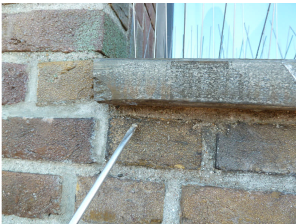
Foto 4.84: Noordgevel: onder de natuurstenen vensterbank zit de voeg wat los (capillairen zijn aanwezig). Komt op meerdere plaatsen voor.
