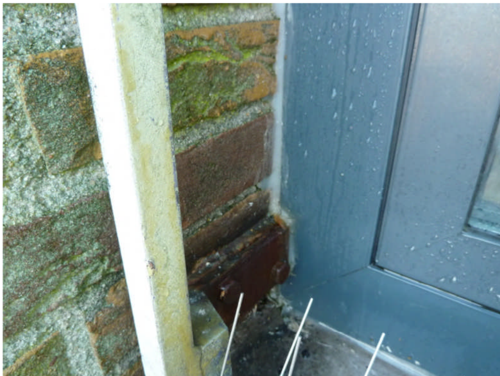
Foto 4.171: Noordgevel (boven klok): bevestiging hekwerk (voor kozijn) ernstig gecorrodeerd.
