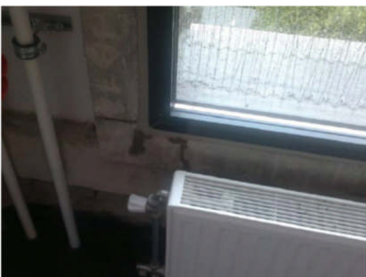
Foto 2.4: Lekkages 6 oktober 2011 – rondom kozijnen.
