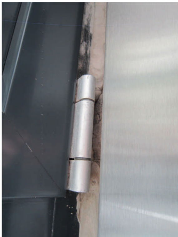
Foto 4.20: Op een aantal plaatsen is de kitdichting, die dient als luchtdichting, achter de scharnieren niet doorgezet.
