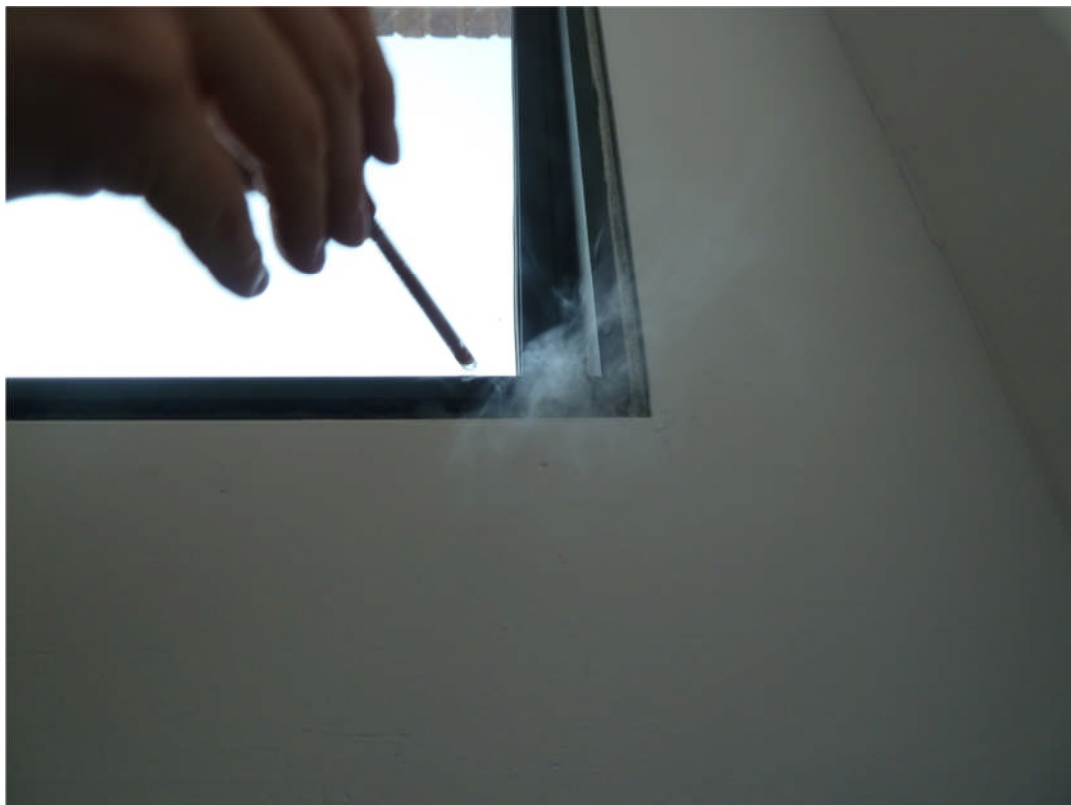
Foto 4.41: 10 e verdieping – luchtlekken ter plaatse van de hoeken van de vensterbank.
