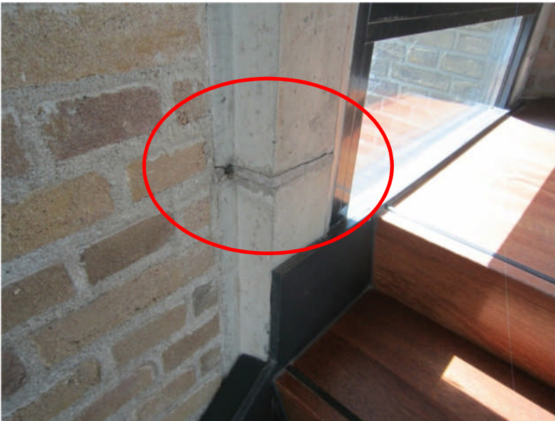
Foto 4.18: Betonnen kader rondom raam – stuiknaden zijn gedicht met mortel echter er is een krimpnaad ontstaan. Tevens is de morteldichting niet meer geheel aanwezig.
