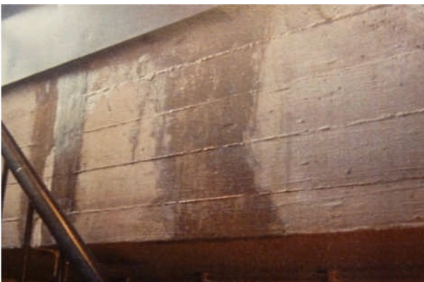
Foto 2.19: Lekkages 25-07-2011 – betonnen kaders.
