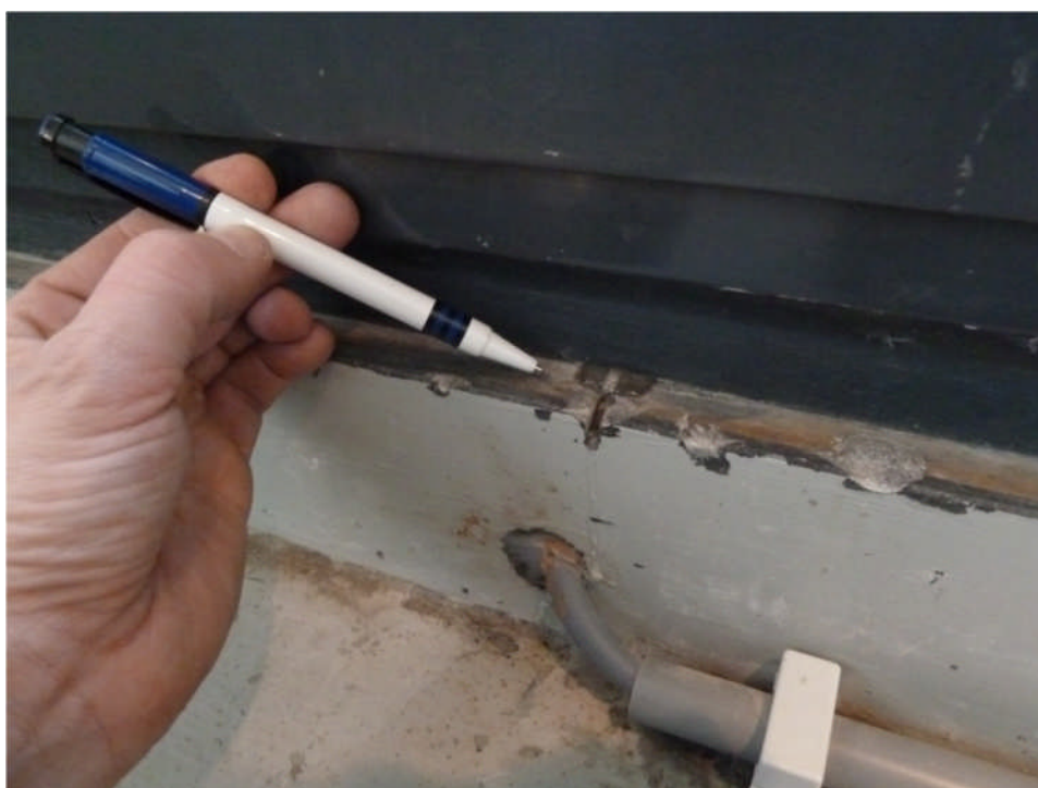
Foto 4.62: Sproeitest 12 e verdieping lifthal - lekkage ter plaatse van de bouwkundige aansluiting kozijn/kit (linker raam).
