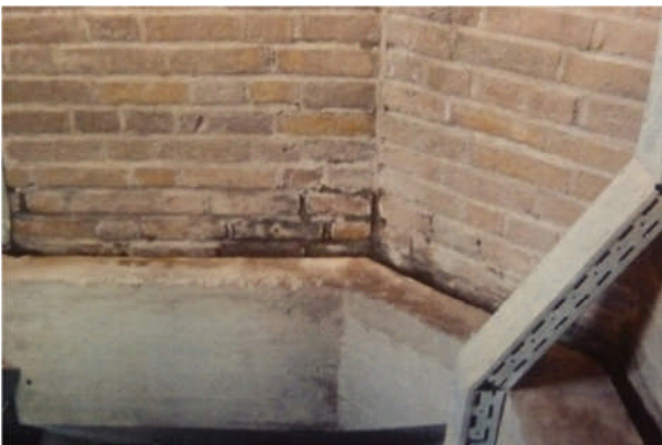
Foto 2.18: Lekkages 25-07-2011 – doorslag door gevel.
