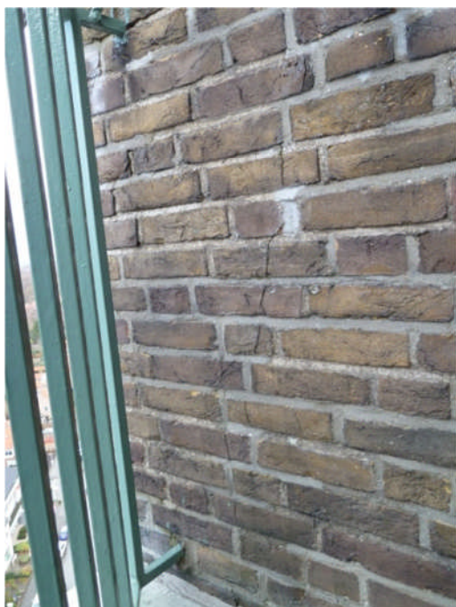
Foto 4.164: Visuele opname dak platform – scheurvorming.
