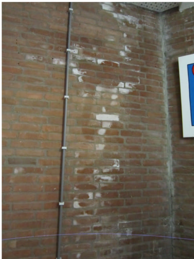
Foto 4.3: Vochtdoorslag 2 e verdieping.
