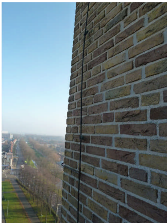
Foto 4.179: Noordgevel: bliksemafleider hangt plaatselijk los.
