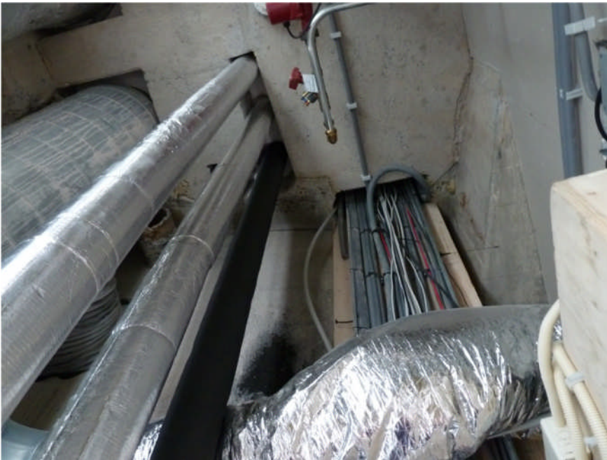
Foto 4.31: 7 e verdieping – zonder onderdruk met een Blower (zie volgende foto) wordt al een luchtstroming uit de schacht ervaren. Met onderdruk is deze luchtstroming vele malen groter. De doorvoeringen van de installaties zijn niet luchtdicht uitgevoerd.
