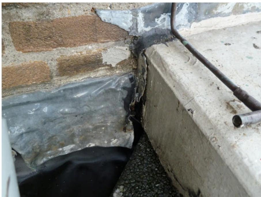
Foto 4.166: Visuele opname dak platform – zeer slordige afwerking/uitvoering van dit detail – zo niet waterdicht.
