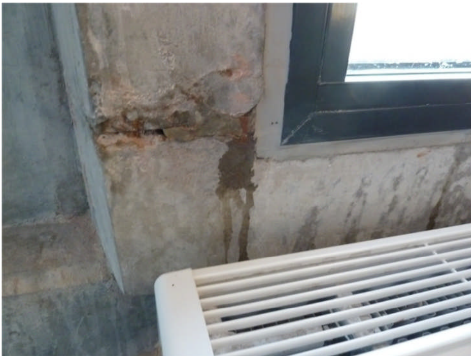
Foto 4.55: Sproeitest 7 e verdieping (overloop) – rechter raam – lekkage ter plaatse van betonnen kader.
