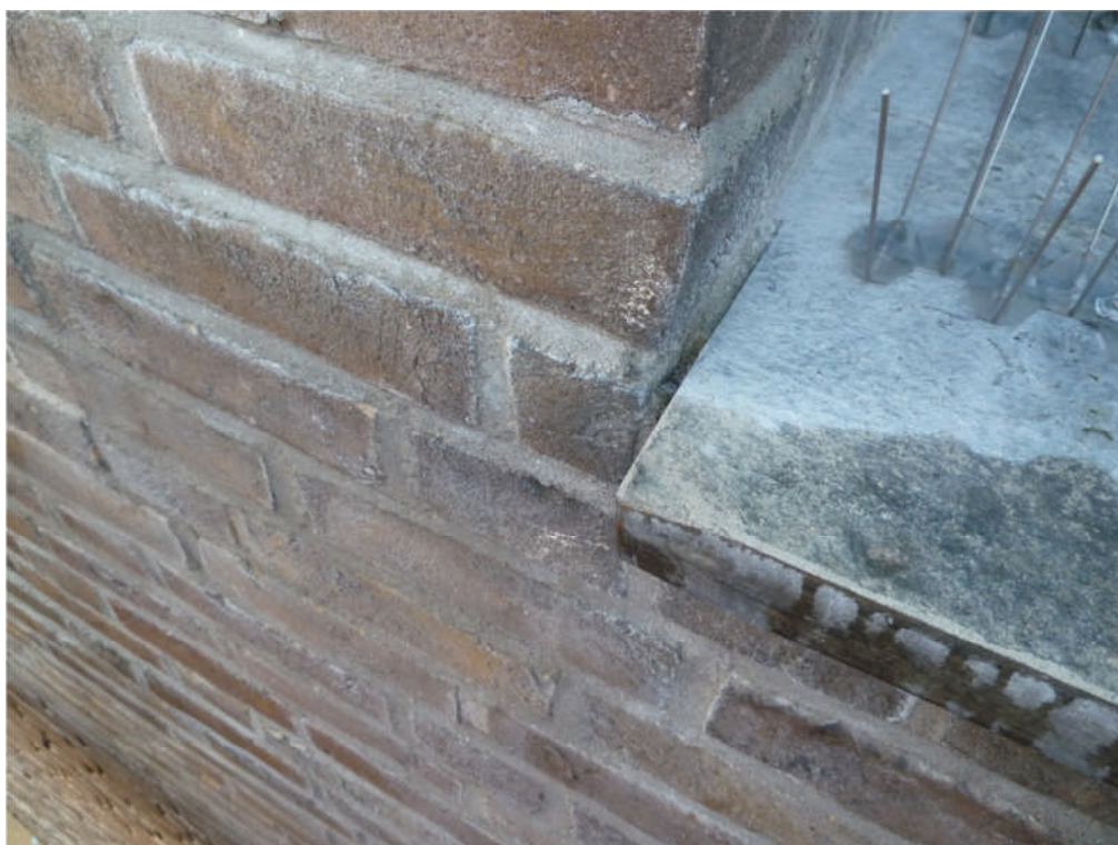
Foto 4.125: Zuidoostgevel: Voeg tussen vensterbank en gevel is niet meer volledig aanwezig.
