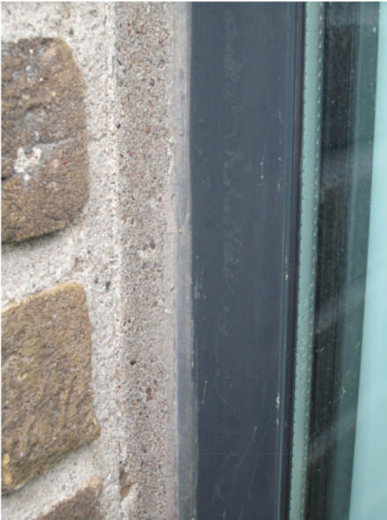
Foto 4.74: De aluminium kozijnen, ter hoogte van de begane grond, zijn (t.p.v. de aansluiting op het bouwkundige kader) rondom niet voorzien van een 'extra' dichtingsband (zoals die hoger wel voorkomt) Op deze foto is het betonnen kader rondom het kozijn zichtbaar. Waar wel een 'extra' dichtingsband is aangebracht is dit kader niet meer zichtbaar.
