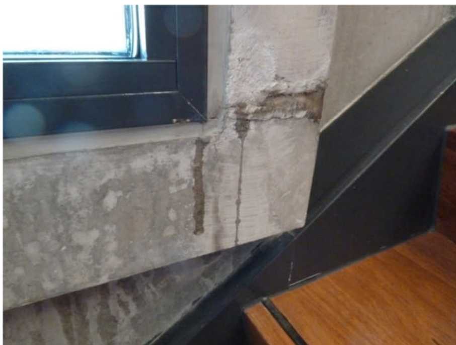
Foto 4.57: Sproeitest 7 e verdieping (overloop) – rechter raam – lekkage ter plaatse van betonnen kader en aansluiting van kozijn.
