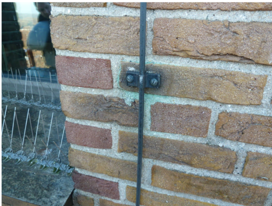
Foto 4.170: Noordgevel: uitloging koper.
