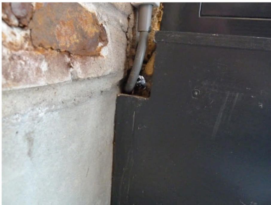
Foto 4.141: Ter plaatse van de toegang tot het platform is bij de kabeldoorvoer een open verbinding tussen binnen en buiten aanwezig.
