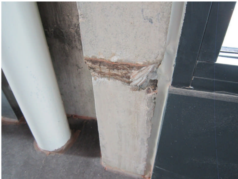
Foto 4.28: De naden tussen de elementen van het betonkader zijn gedicht met kit (of andere middelen zoals mortel). Te zien is dat dit onzorgvuldig is gebeurd. Een goede dichting is hier dus niet aanwezig.
