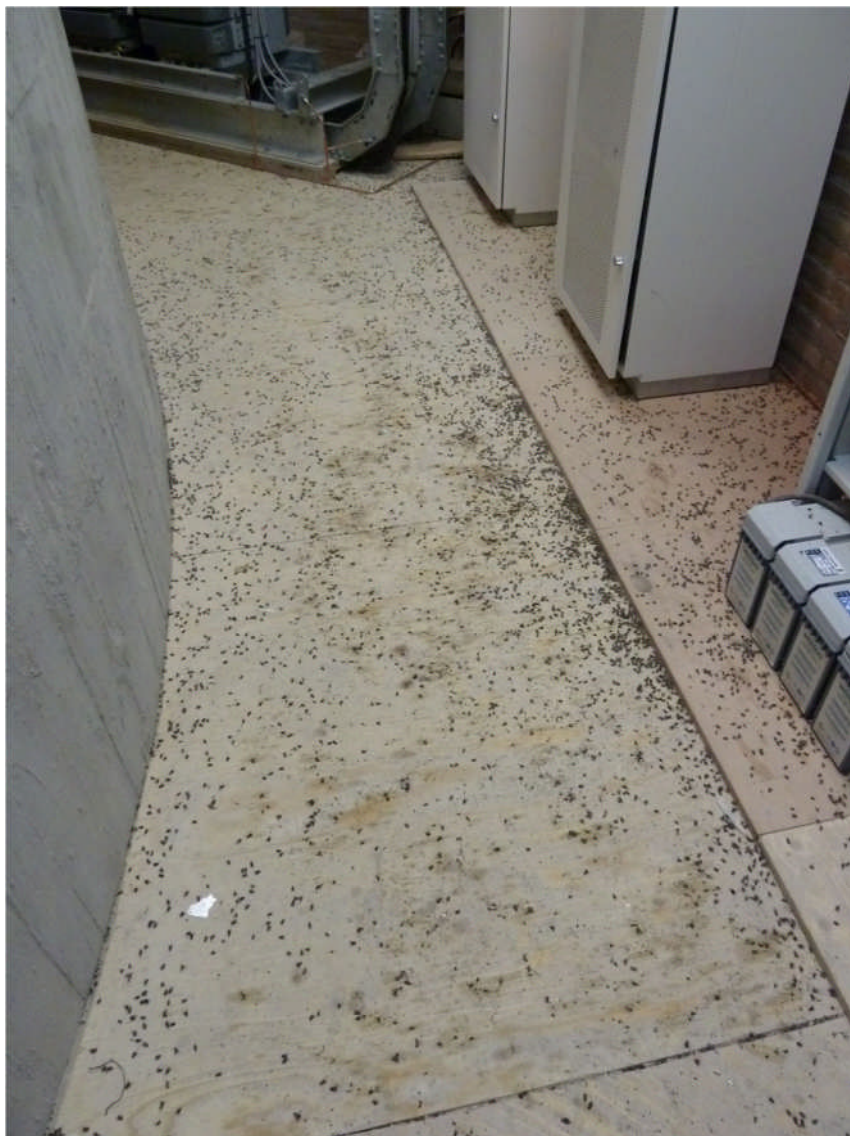
Foto 1: Dode muggen/vliegen in Telecomruimte.
