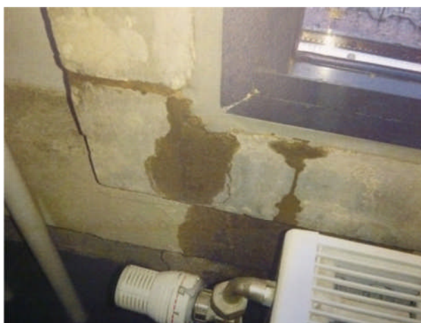
Foto 2.13: Lekkages 23-10-2010 – betonnen kaders, aansluiting kozijn en kozijn zelf.
