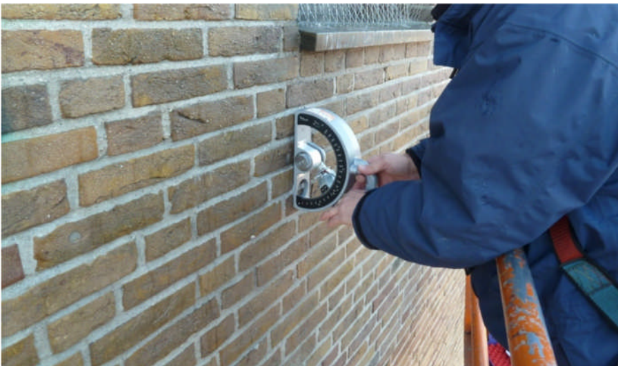
Foto 4.92: Noordgevel: op een aantal plekken zijn voeghardheidsmetingen verricht. Waarden net onder de klok: 55/65/50/40/65/65/50/50/33 (middelste waarde 55). Waarden boven de klok: 48/60/60/50/50/65/55/60/55 (middelste waarde 55). Waarden boven de klok – nieuw voegwerk: 37/45/65/50/45/55/50/55/50 (middelste waarde 55).
