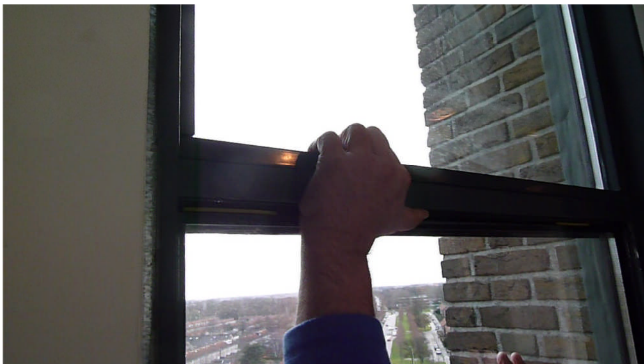
Foto 2: Instabiele tussendorpel (kalf) op de 7 e verdieping (westgevel).
