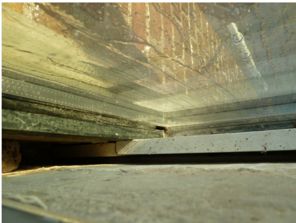
Foto 4.27: 8 e verdieping – overloop: ook hier sluiten de rubbers in de hoeken niet. Overigens is deze plek vrijwel niet bereikbaar vanwege de vloerrand. Ook onderhoud (reiniging) is hier niet mogelijk.
