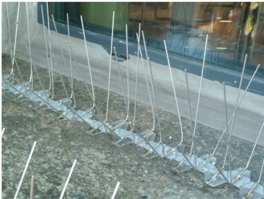
Foto 4.89: Noordgevel: kapje voor ontwateringssleuf ontbreekt.
