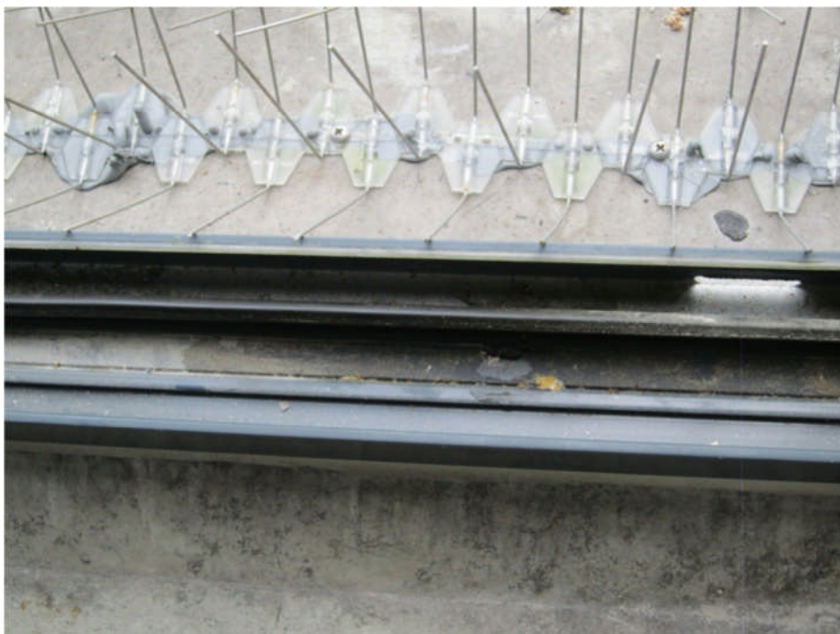
Foto 4.2: Vochtsporen achter de middendichting in het raam (komt op meerdere plaatsen voor).
