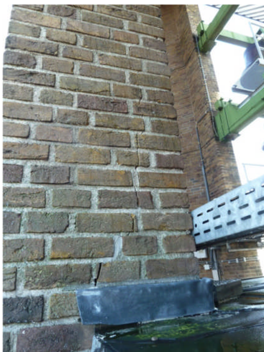
Foto 4.102: Noordgevel (t.p.v. dak daktoegang platform): grote scheur in metselwerk (scheurwijdte: variërend van circa 0,2 – 3 mm).
