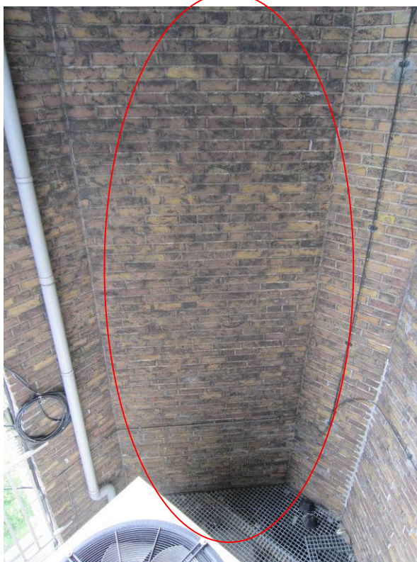
Foto 2 Doordrenkt metselwerk aan binnenzijde carillon.
