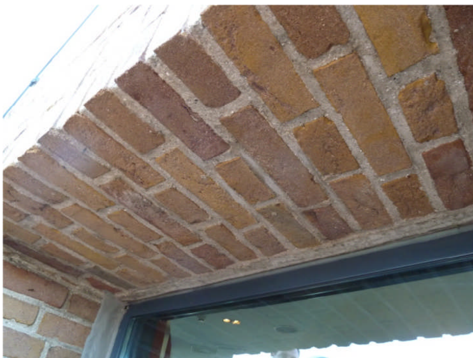
Foto 4.94: Noordgevel: aan de bovenzijde is de bouwkundige aansluiting tussen kozijn en gevel niet afgedicht met een kitband.
