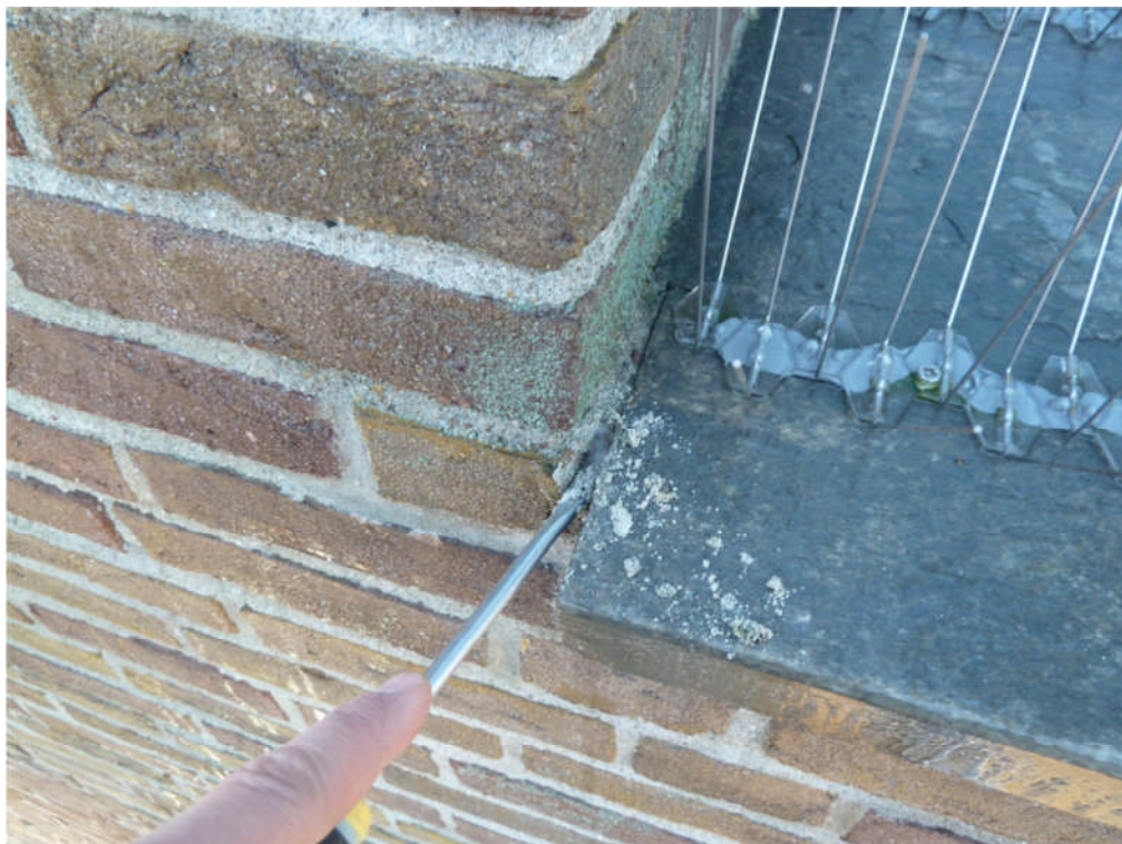
Foto 4.85: Noordgevel: voeg tussen leistein afdekker en gevel 'verpulpt'. Komt op meerdere plaatsen voor.
