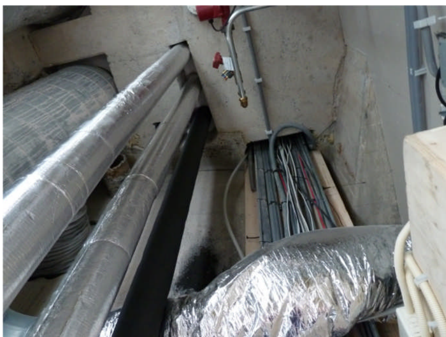
Foto 4.180: 7 e verdieping – zonder onderdruk met een Blower wordt al een luchtstroming uit de schacht ervaren (zie ook paragraaf 4.3). Met onderdruk is deze luchtstroming vele malen groter. De doorvoeringen van de installaties zijn niet luchtdicht uitgevoerd. Ook een goede branddichting is dus niet aanwezig.
