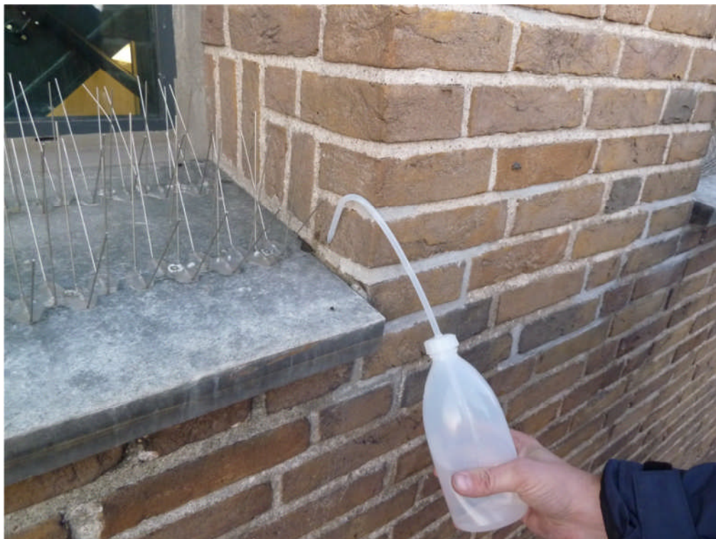
Foto 4.135: Zuidwestgevel: slechte voeg – neemt vrijwel al het water op en laat dat door richting 'spouw/gevel'.
