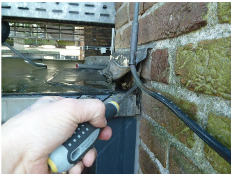
Foto 4.100: Noordgevel: loodaansluiting ter plaatse van dak (van daktoegang platform) is niet waterdicht. Zowel links als rechts – zie ook de volgende foto. Er is geen dakrand aanwezig. Water van het dakje wordt over de rand via de gevel afgevoerd.
