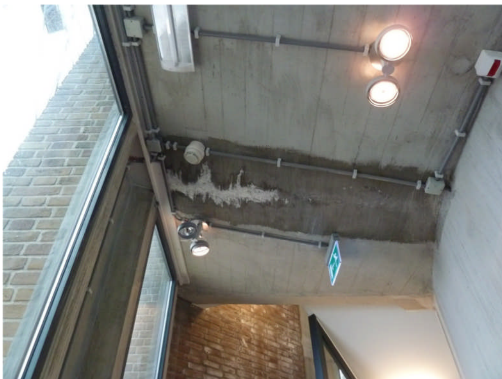
Foto 4.13: Leksporen ter plaatse van het plafond – 7 e verdieping (overloop).
