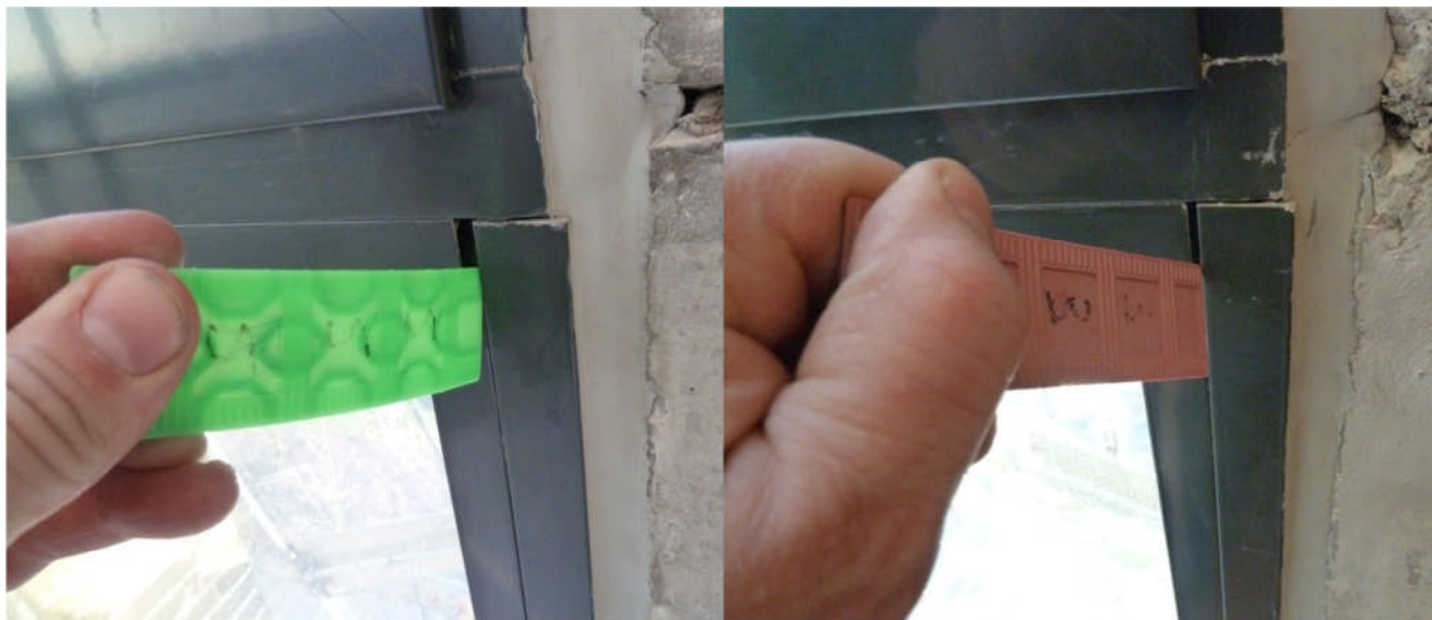
Foto 4.26: 8 e verdieping – overloop: openingen tussen glaslatten soms wel 3-5 mm. Maximale maat is 0,5 mm volgens VMRG.
