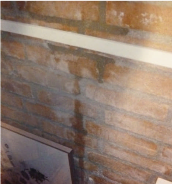
Foto 2.17: Lekkages 23-10-2010 – doorslag door gevel.
