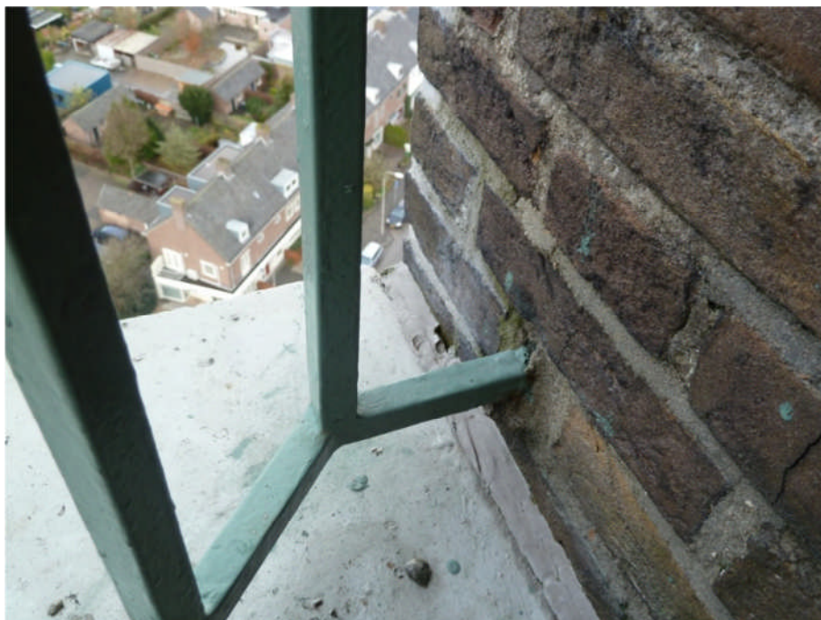
Foto 4.163: Visuele opname dak platform – voeg tussen beton en gevel hecht niet meer overal, dus niet waterdicht.
