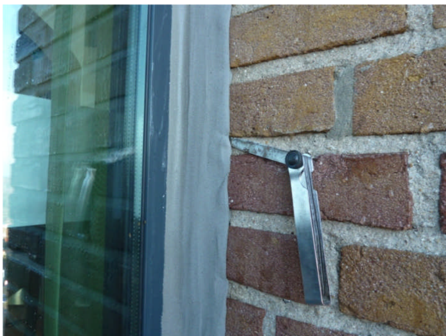
Foto 4.90: Noordgevel: in tegenstelling tot het begane grondniveau is de aansluiting van de aluminium kozijnen op de gevel rondom (met uitzondering van de bovendorpel), op de hoger gelegen verdiepingen, aanvullend afgedicht met een kitband. Dit band sluit echter niet overal goed aan op de soms iets dieper liggende lintvoegen.
