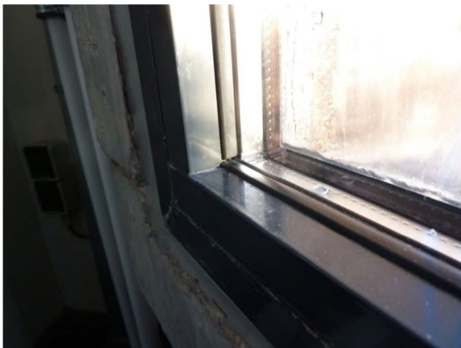
Foto 4.23: 7 e verdieping (overloop) - op diverse plaatsen sluiten de beglazingsrubbers in de hoeken niet. De constructie is zo onvoldoende luchtdicht en de kans op lekkages wordt hierdoor aanzienlijk vergroot.
