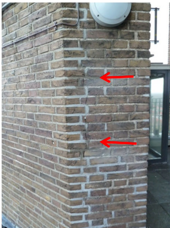
Foto 4.150: Visuele opname dak platform – scheurvorming (is eerder hersteld).
