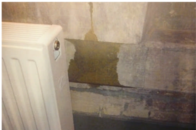
Foto 2.14: Lekkages 23-10-2010 – betonnen kaders.
