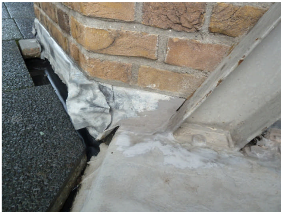
Foto 4.155: Visuele opname dak platform - lood loopt achter staalconstructie niet door. Is dus maar moeilijk waterdicht te krijgen – potentieel lek. Lood slordig aangebracht (niet goed aangeklopt).
