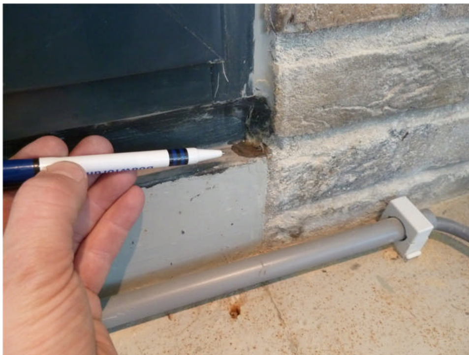
Foto 4.63: Sproeitest 12° verdieping lifthal - lekkage ter plaatse bouwkundige aansluiting kozijn (linker raam).
