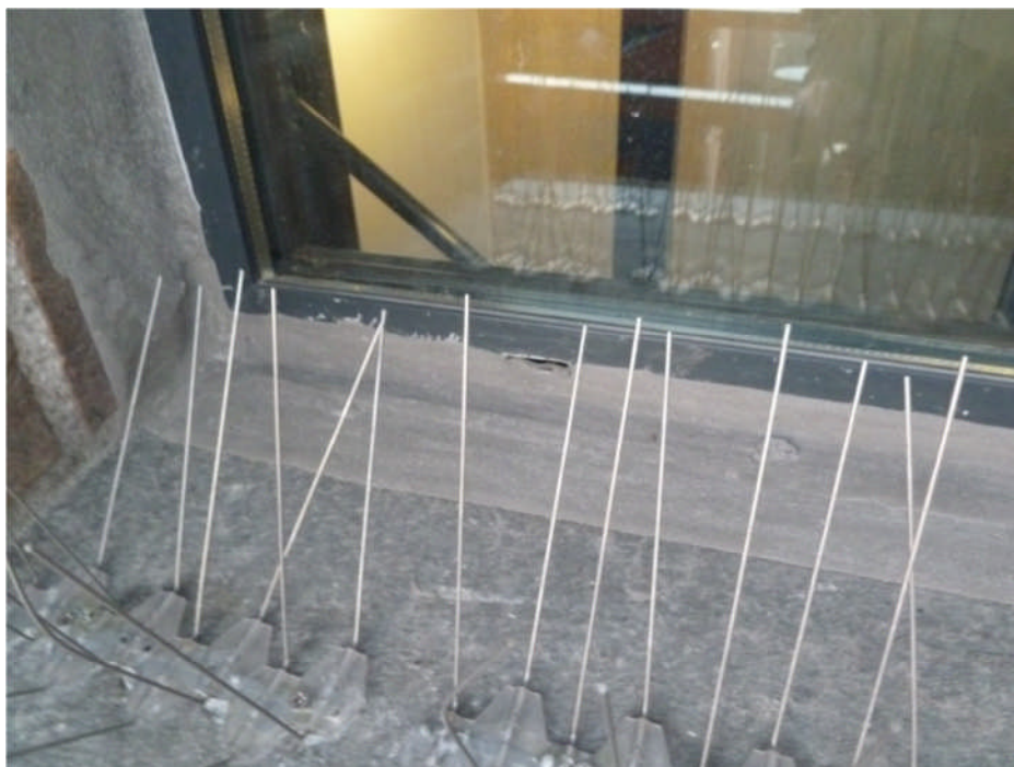
Foto 4.134: Zuidwestgevel: missende kapjes op ontwateringsleuf.
