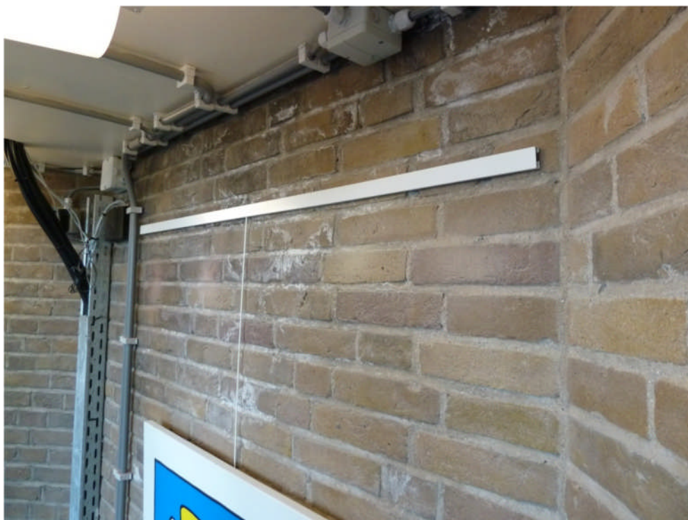
Foto 4.8: Vochtdoorslag ter plaatse van aansluiting vloer/gevel.
