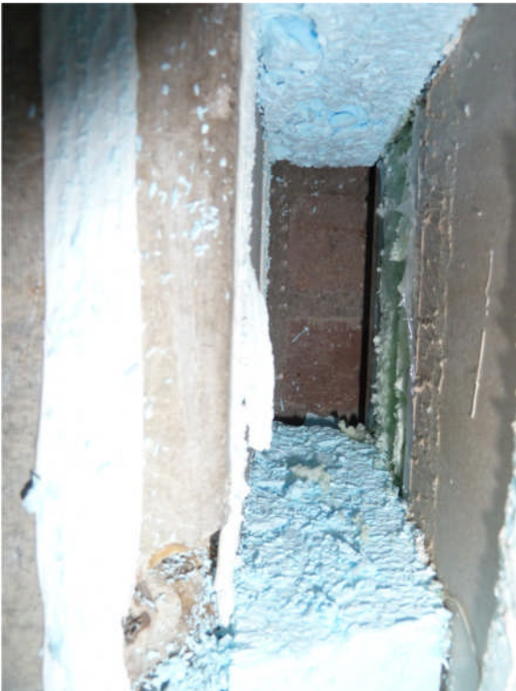
Foto 4.49: Na het verwijderen van een stuk XPS (naast het betonkader) is de buitengevel zichtbaar. Achter de voorzetwand is een kleine spouw aanwezig. Uit deze spouw komt relatief koude lucht. Ook niet vreemd want het metselwerk is sterk onderhevig aan de buitentemperatuur. Echter door een slechte luchtdichting (aan de binnenzijde) – zie hiervoor ook paragraaf 4.3 - komt deze koude lucht wel naar binnen.
