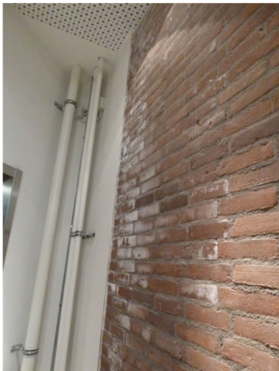
Foto 4.15: Vochtdoorslag gevel – 10° verdieping.
