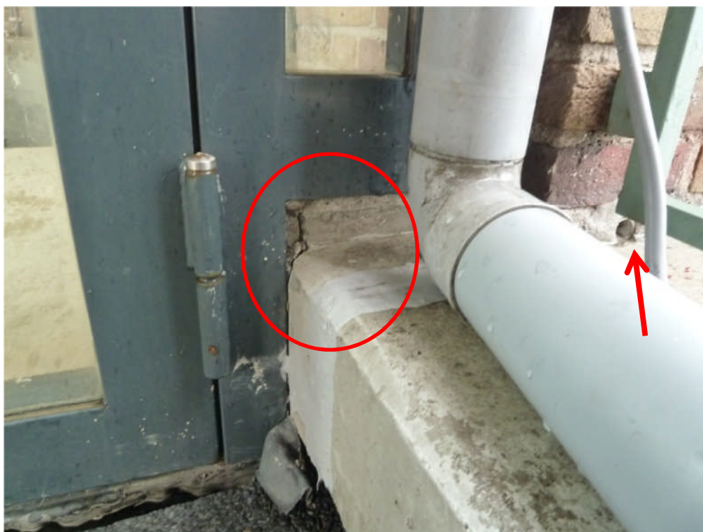
Foto 4.157: Visuele opname dak platform – opening aanwezig van binnen naar buiten / constructie is niet waterdicht (betonrand sluit niet waterdicht op gevel).
