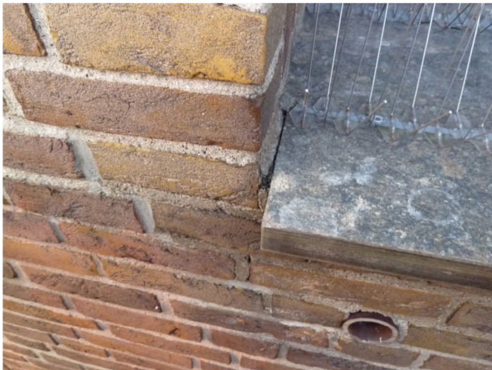
Foto 4.131: Zuidgevel: voeg tussen vensterbank en gevel laat los.
