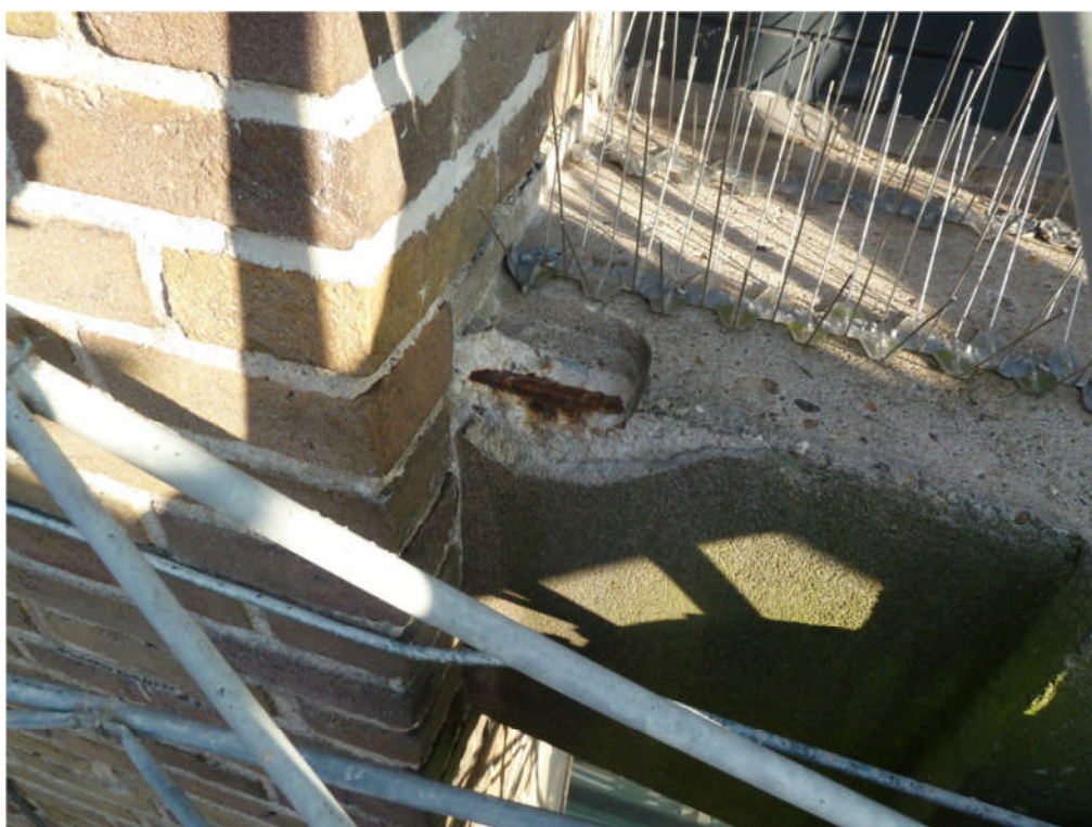
Foto 4.174: Westgevel ter plaatse van klok: betonrot/roestende wapening.
