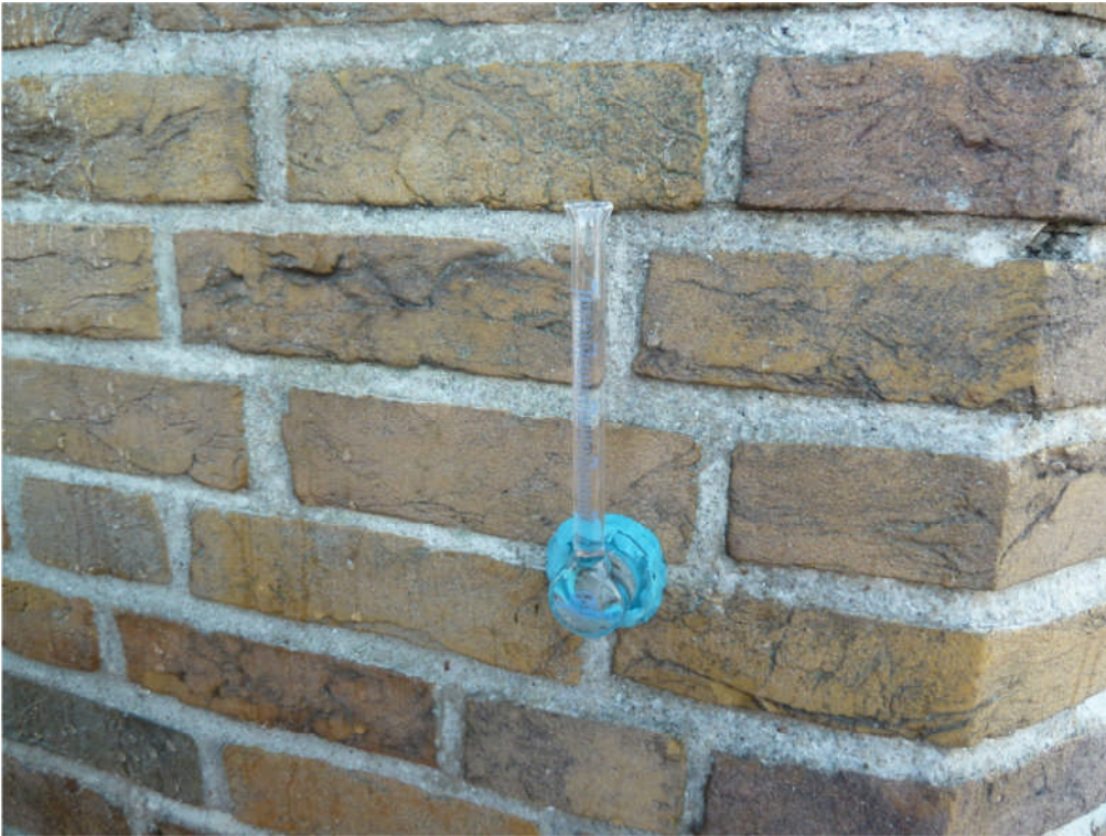
Foto 4.103: Noordgevel ter hoogte van het platform: Op een drietal plaatsen is, om de waterwerendheid van het metselwerk te bepalen, de Karstenmethode gedaan. Het waterpeil zakt nagenoeg niet (buisje is geheel gevuld).
