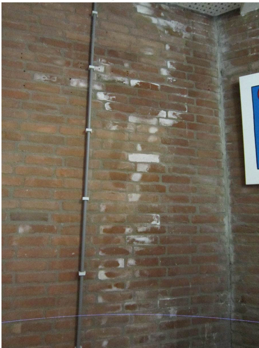
Foto 5 Waterdoorslag zichtbaar op binnenmuur.
