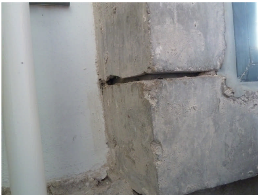
Foto 4.29: 7 e verdieping (overloop) – enkele naden tussen de betonnen elementen staan zelfs (deels) open.
