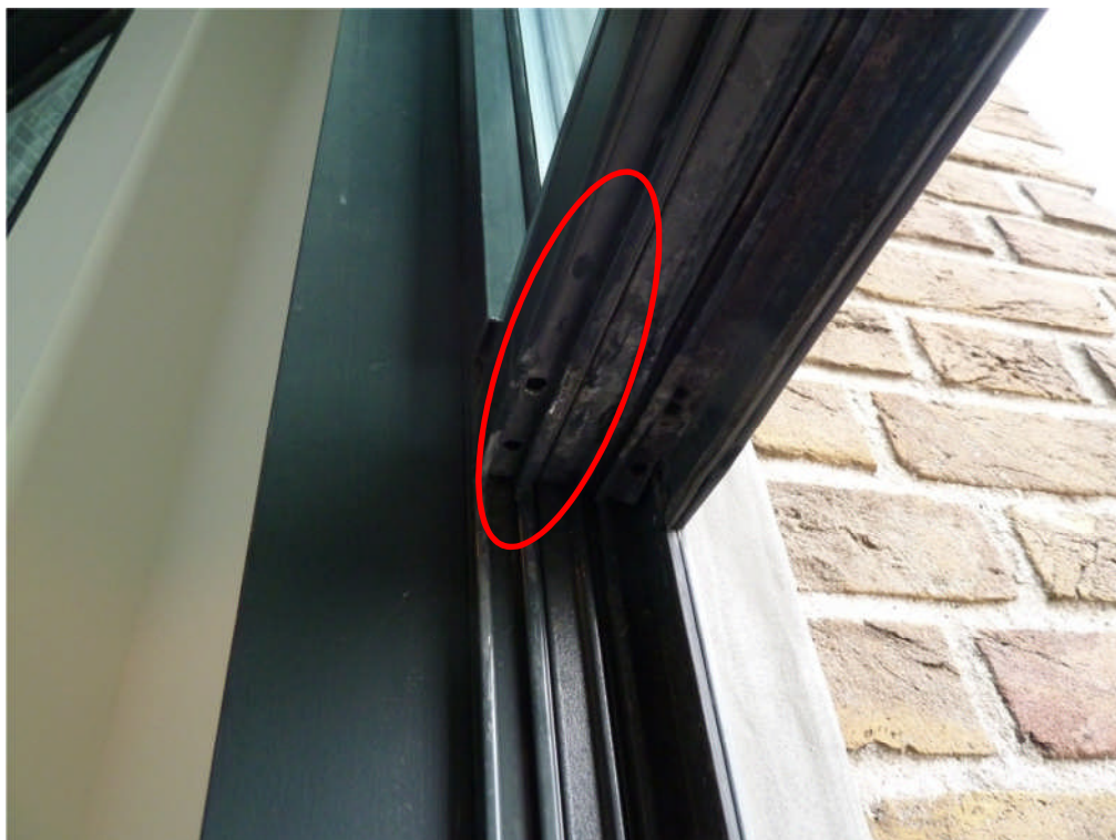
Foto 4.46: Na verwijderen van het glas blijkt dat er vochtsporen in de onderzijde van het tussenkalf aanwezig zijn. Deze vochtsporen liggen te ver naar binnen waardoor lekkages bij het ondergelegen raam goed te verklaren zijn.
