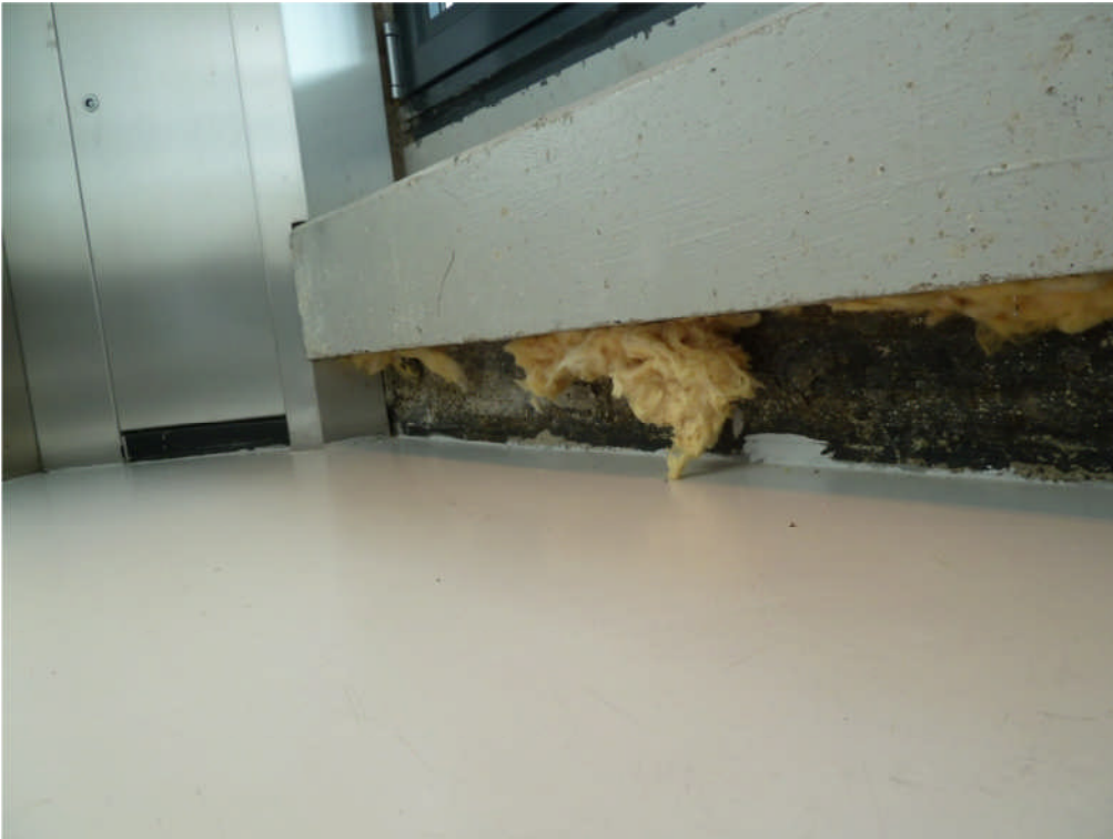
Foto 4.30: 12 e verdieping – lifthal: onder het betonnen kader is geen luchtdichting aanwezig. Hier is getracht de constructie te dichten met minerale wol. Minerale wol is niet luchtdicht.
