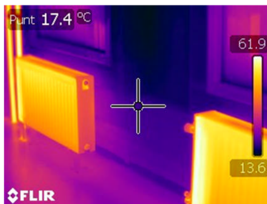
Foto 4.67b: Temperaturen ongeïsoleerde gevel met daarvoor een tweetal radiatoren.
