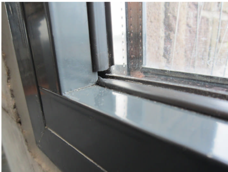
Foto 4.22: Op diverse plaatsen sluiten de beglazingsrubbers in de hoeken niet. De constructie is zo onvoldoende luchtdicht en de kans op lekkages wordt hierdoor aanzienlijk vergroot.
