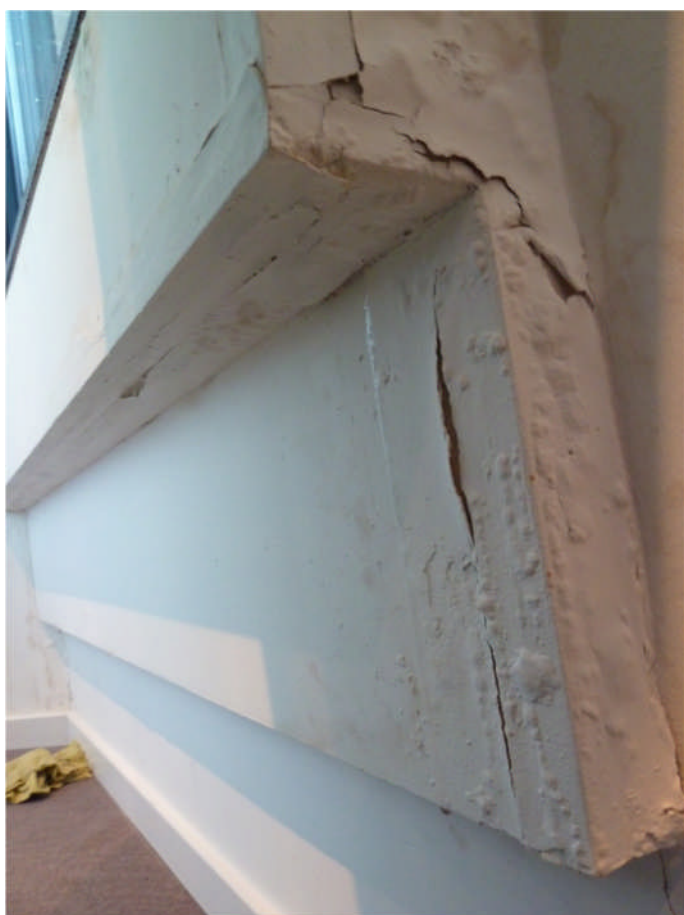
Foto 4.50: Sproeitest 7 e verdieping (restaurant) - lekkage binnen enkele minuten onder het raam – bouwkundig kader.
