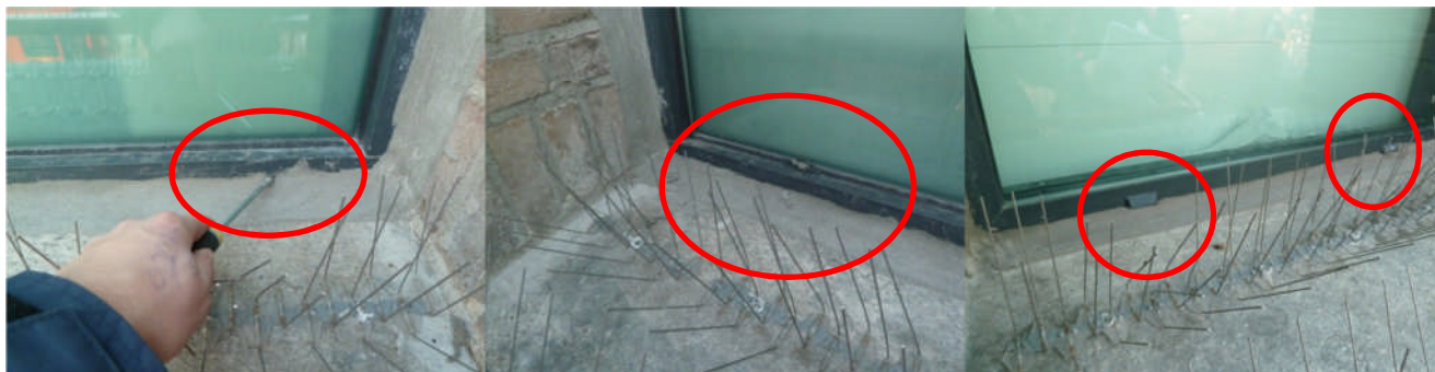
Foto 4.126a, -b en -c: Zuidoostgevel: Ontwateringsgaten kozijn achter (en vlak boven) voegdichting (geen ontwatering meer mogelijk).
