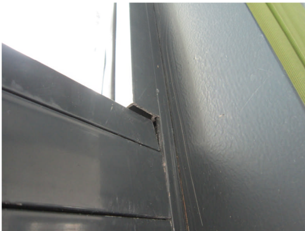
Foto 4.25: Glaslatten liggen niet in één vlak en sluiten in de hoeken slecht.
