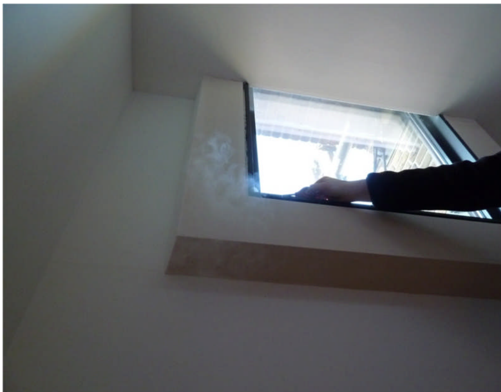
Foto 4.40: 10 e verdieping – luchtlekken ter plaatse van de hoeken van de vensterbank.
