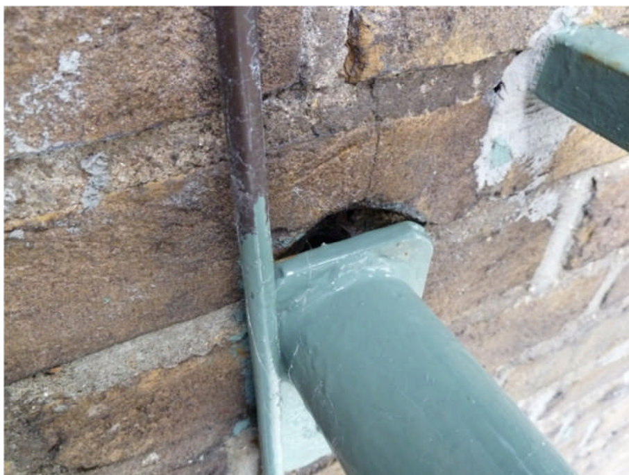
Foto 4.168: Visuele opname dak platform – aansluiting baluster – grote opening in metselwerk – kans op waterinfiltratie en vorstschade.
