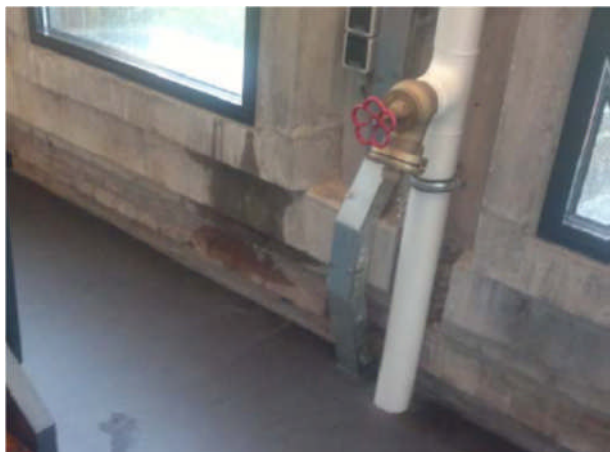
Foto 2.6: Lekkages 6 oktober 2011 – rondom kozijnen/betonnen kaders.
