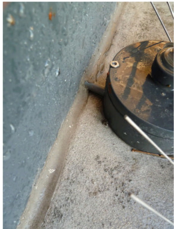
Foto 4.60: Sproeitest 12 e verdieping lifthal - lekkage ter plaatse doorvoering kabel (linker raam). Foto rechts is situatie buiten.
