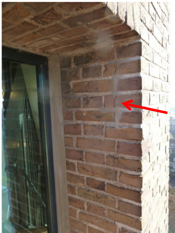
Foto 4.120: Westgevel: plaatselijke scheuren in metselwerk aanwezig. Ook al eerder gerepareerd.
