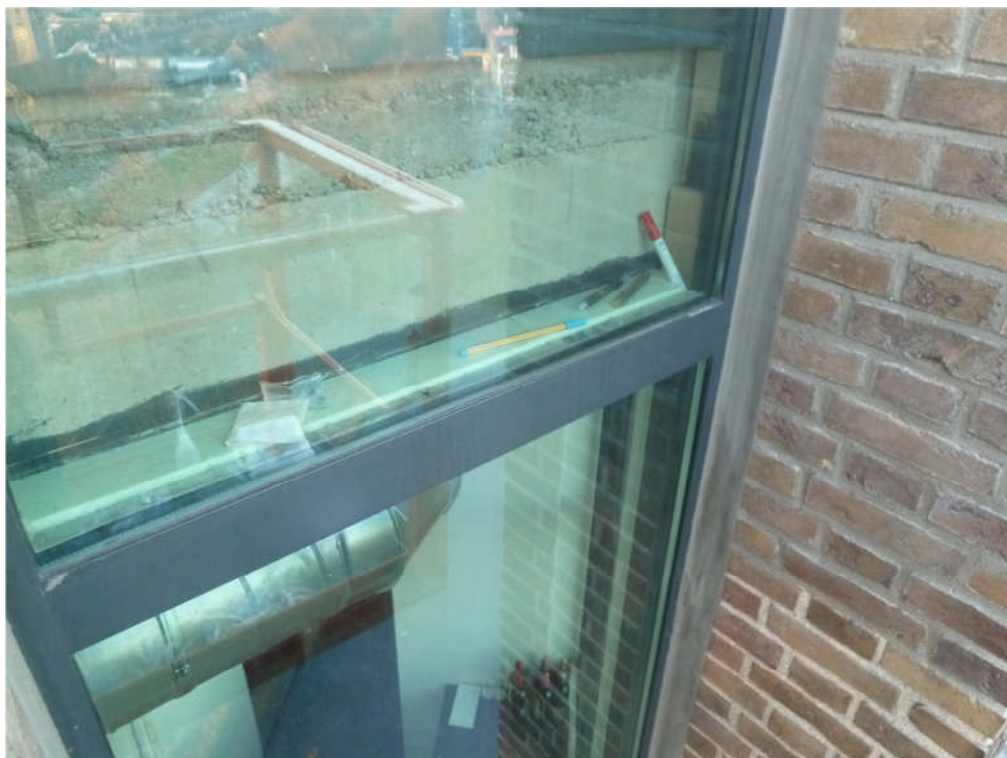
Foto 4.177: Zuidoostgevel: vloerranddetail – is dit wel voldoende brandwerend (verticaal)?
