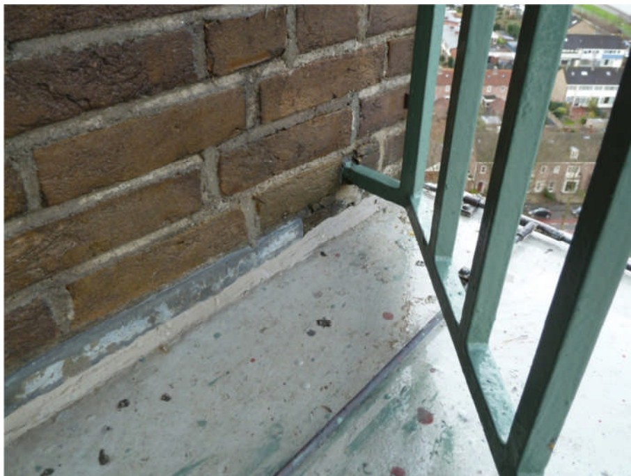
Foto 4.165: Visuele opname dak platform – lood loopt onvoldoende ver door – aansluiting metselwerk op betonrand is zo niet waterdicht.
