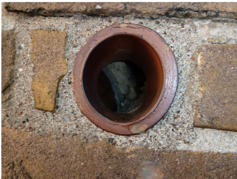
Foto 4.132: Zuidgevel: drainagebuisjes – te zien is dat deze eindigt in de 'spouw'.
