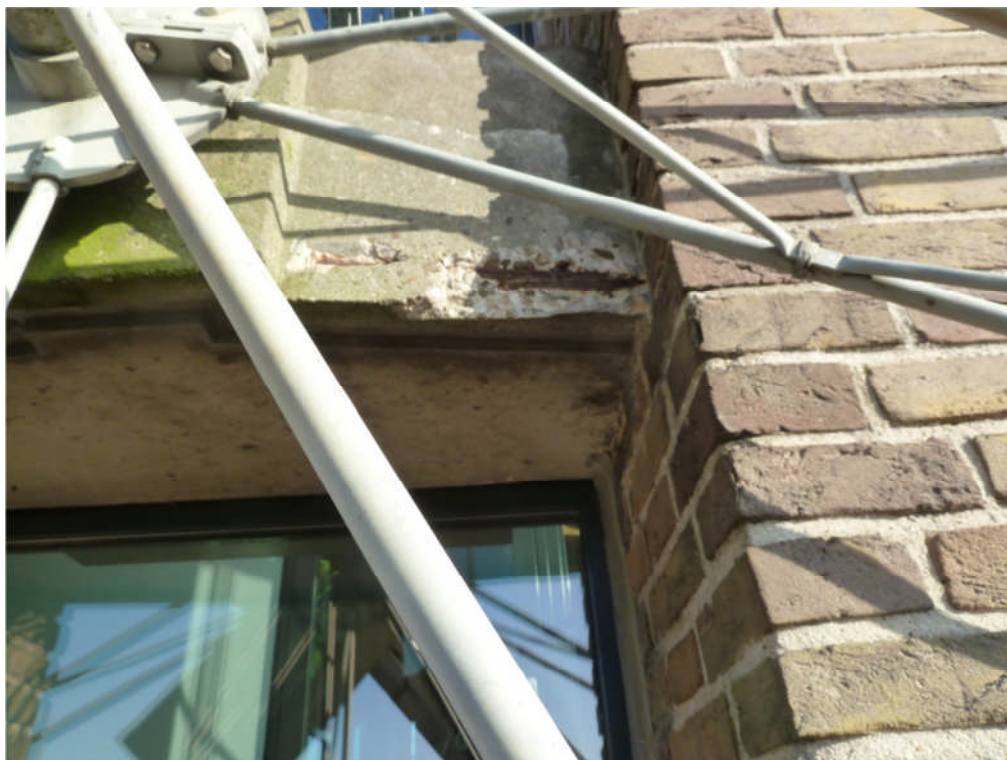
Foto 4.173: Westgevel ter plaatse van klok: betonrot/roestende wapening.
