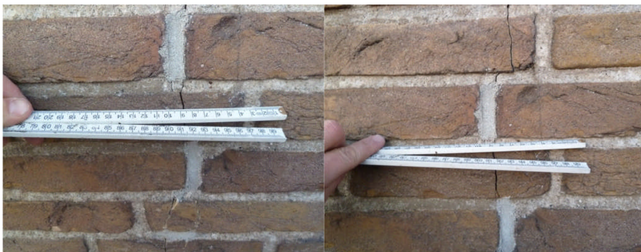
Foto 4.136a en -b: Zuidwestgevel: scheur t.p.v. 6 e verd. vloer (komt van de 7 e ). Loopt naar onder door tot 3 e verd. (hier circa 1-2 mm). Deze scheur is al eerder hersteld.
