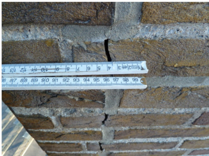
Foto 4.104: Noordwestgevel (ter hoogte van het platform): Grote scheur (scheurwijdte circa 4 mm). Deze scheur is eerder hersteld – zie volgende foto.
