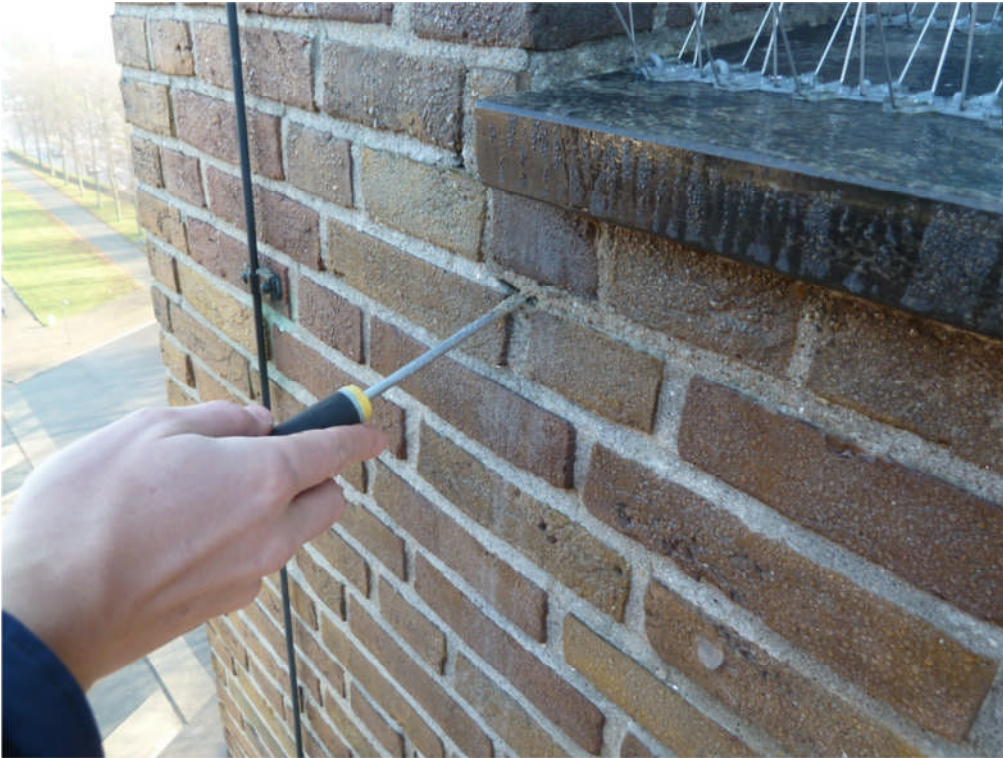
Foto 4.91: Noordgevel: op een enkele plek (incidenteel) is het voegwerk er plaatselijk eenvoudig uit te krabben. Waarschijnlijk is hier het voegwerk aangetast door de continue waterbelasting als gevolg van de vensterbank afstromend regenwater. Overigens hebben de vensterbanken maar een beperkt afschot waardoor afwatering niet altijd (afhankelijk van de wind) kan plaatsvinden.
