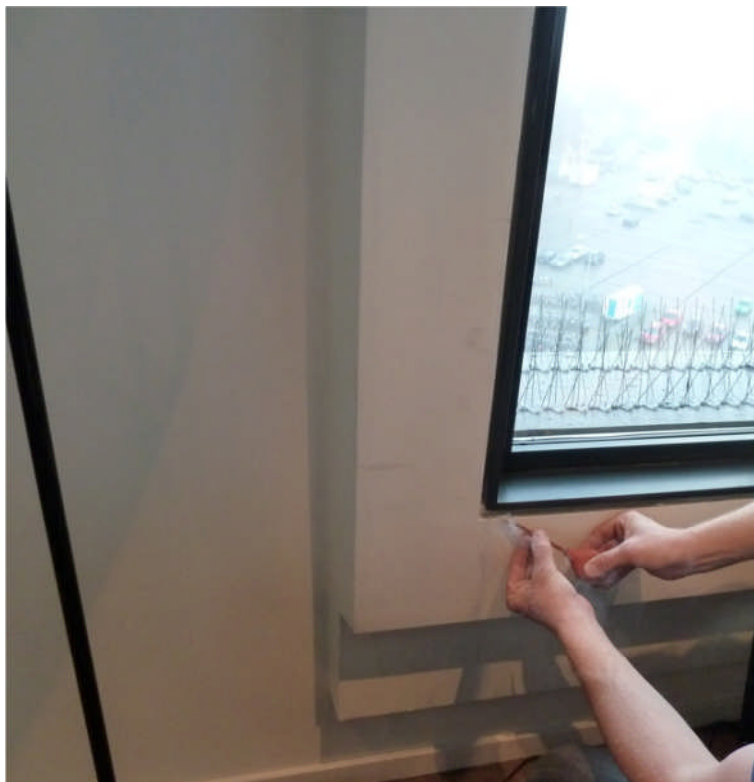
Foto 4.35: 7 e verdieping – luchtlekkages t.p.v. de aansluiting van de vensterbank op de gipsplaat – hier is ook geen luchtdichting (kitvoeg) aanwezig.
