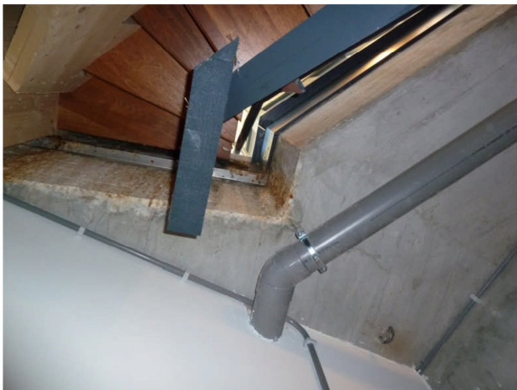
Foto 4.10: Leksporen ter plaatse van plafond, komend vanaf het dak.
