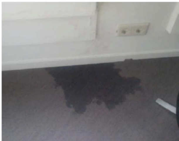
Foto 2.5: Lekkages 6 oktober 2011 – rondom kozijnen.
