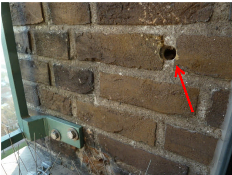
Foto 4.81: 12 e verdieping (lifthal) – op een enkele plek zijn oude boorgaten in de gevel aanwezig. Inwatering (en vorstschade) is zo mogelijk.
