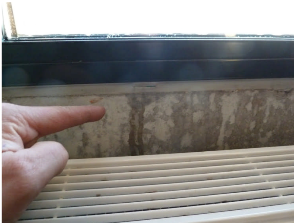
Foto 4.56: Sproeitest 7 e verdieping (overloop) – rechter raam – lekkage ter plaatse van de aansluiting van het kozijn op het betonnen kader.
