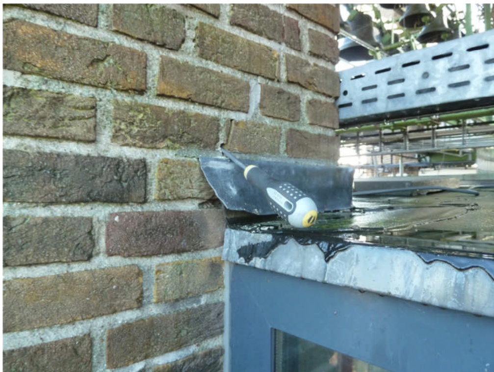
Foto 4.101: Noordgevel: loodaansluiting ter plaatse van dak (van daktoegang platform) is niet waterdicht. Zowel links als rechts – zie ook vorige foto. Ook het voegwerk is hier uit te krabben.
