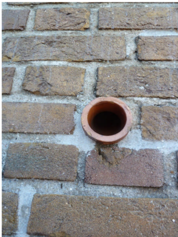
Foto 4.99: Noordgevel: drainage buis boven kozijn (deze komt van boven).
