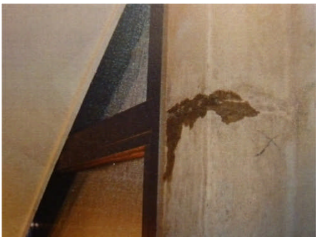
Foto 2.10: Lekkages 12-11-2010 – betonnen kaders.
