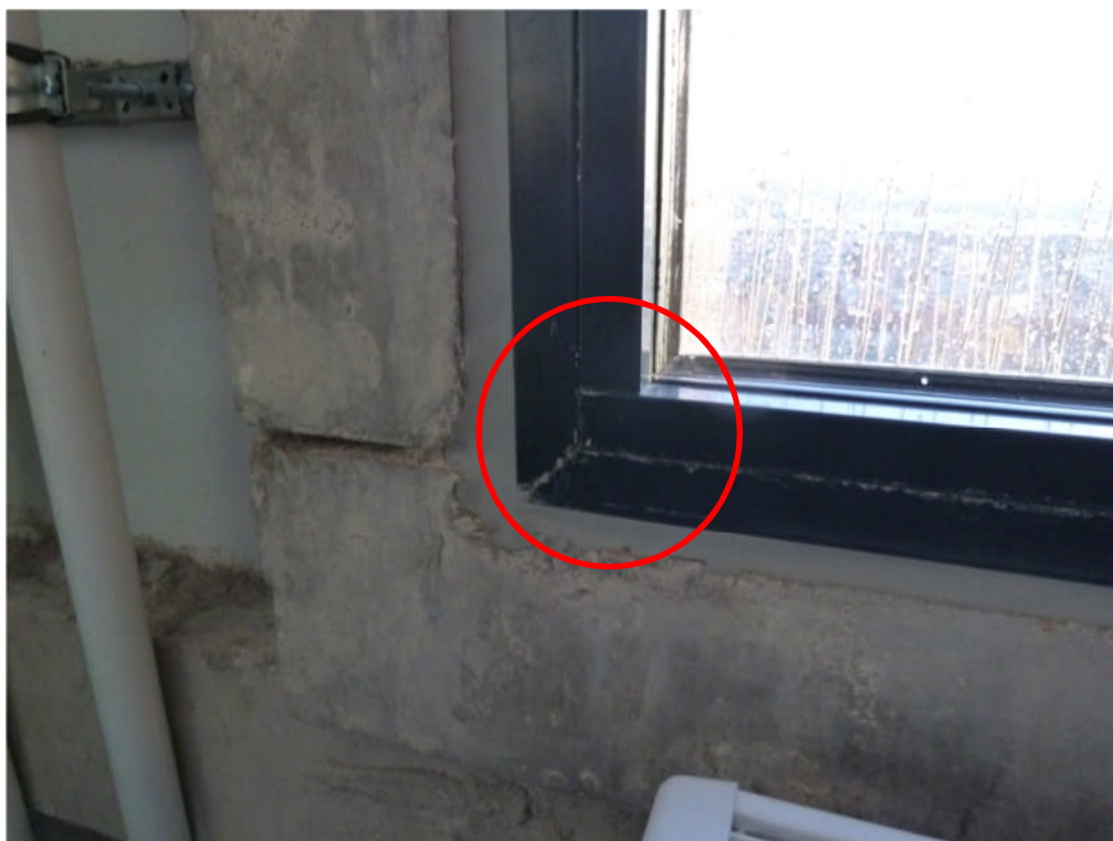
Foto 4.16: 7° verdieping (overloop) – lekkagesporen (kalkresten) bij glaslatten en kozijnverstek.
