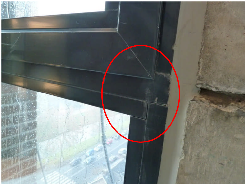
Foto 4.17: 8 e verdieping (overloop naar boven) – lekkagesporen (kalkresten) bij glaslatten en kozijnverstek.
