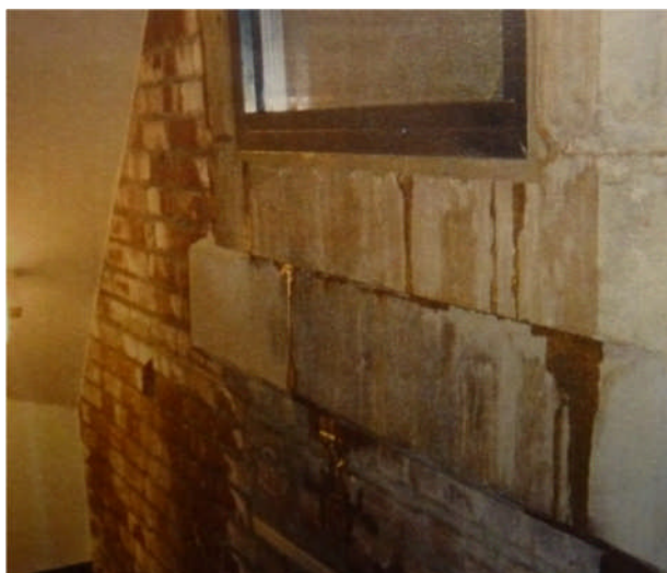
Foto 2.7: Lekkages 12-11-2010 – betonnen kaders en doorslag door gevel.
