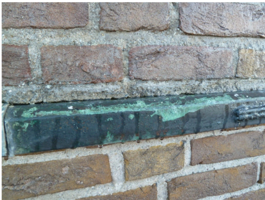
Foto 4.110: Noordwestgevel: koperen rand ter plaatse van platform. Voegwerk er boven laat los (capillair).
