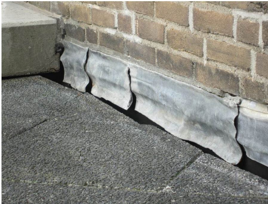
Foto 1 Slecht lood ter hoogte van uitkijkdak boven op de toren.
