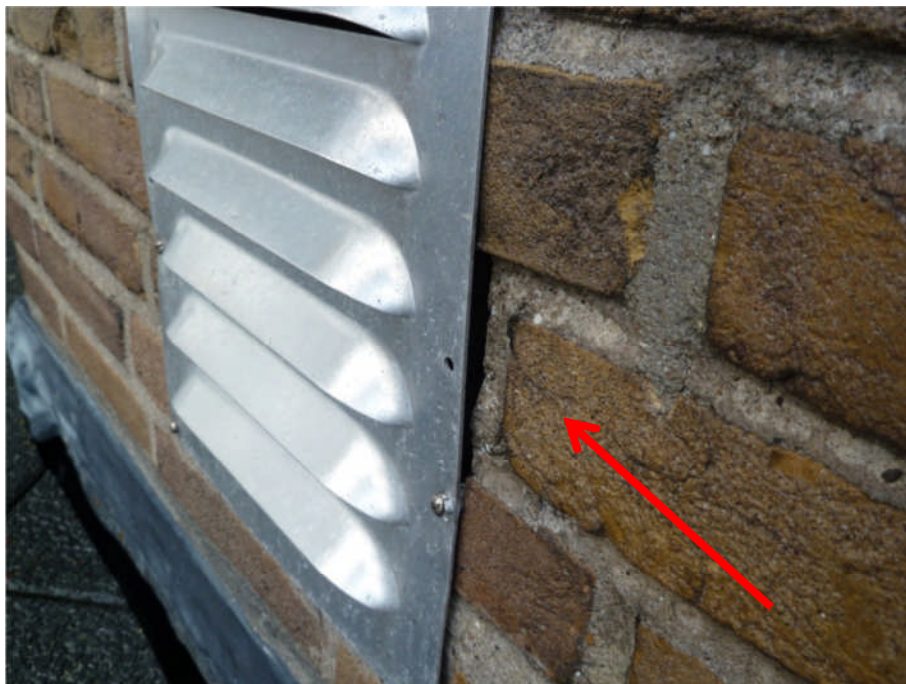
Foto 4.167: Visuele opname dak platform – rooster sluit niet waterdicht aan op de gevel. Grote opening aanwezig.
