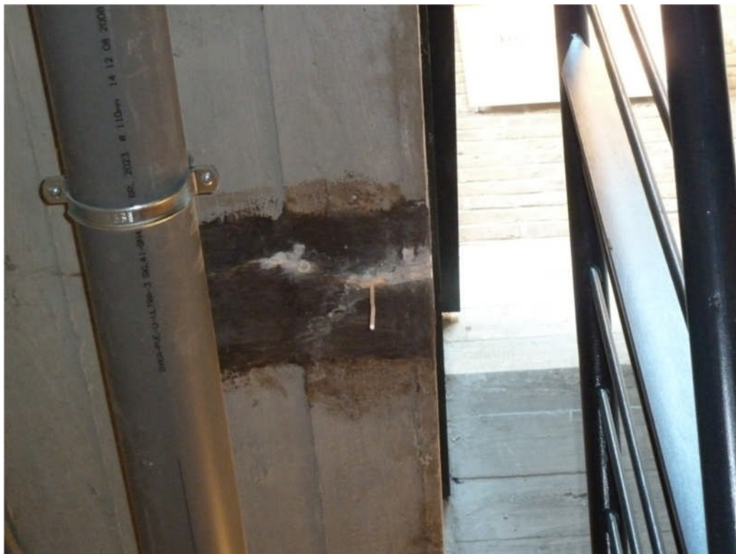
Foto 4.11: Leksporen en kalkpegel ter plaatse van plafond.
