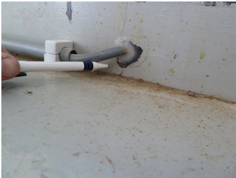
Foto 4.65: Sproeitest 12 e verdieping lifthal - lekkage ter plaatse doorvoering kabel (rechter raam).
