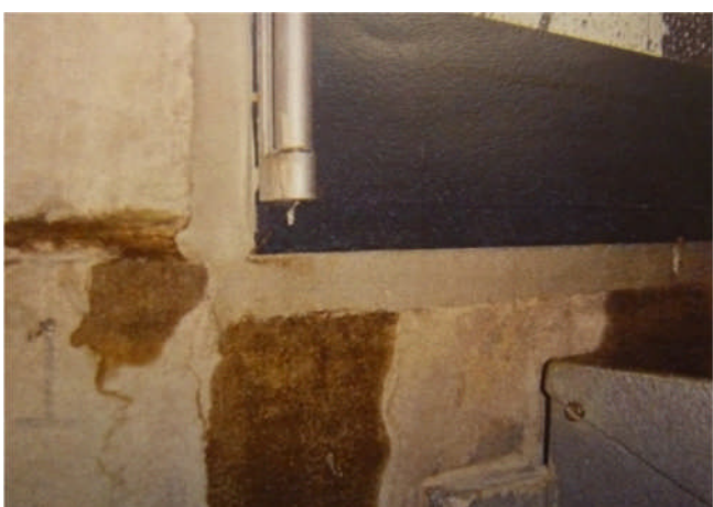
Foto 2.9: Lekkages 12-11-2010 – betonnen kaders.
