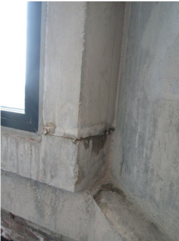
Foto 4.6: Leksporen ter plaatse van de stuiknaden van de betonnen kaders.
