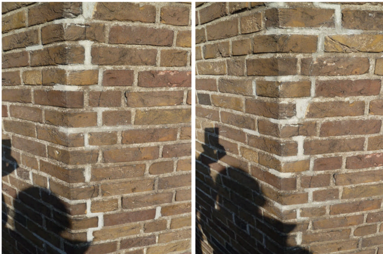
Foto 4.118a en -b: Westgevel: scheur t.p.v. hoek west/zuidwest; lopend op zuidwest tussen 6 e verd. vloer naar circa 7 e verd. vloer (variërend van circa 0,2 mm – 1 mm).
