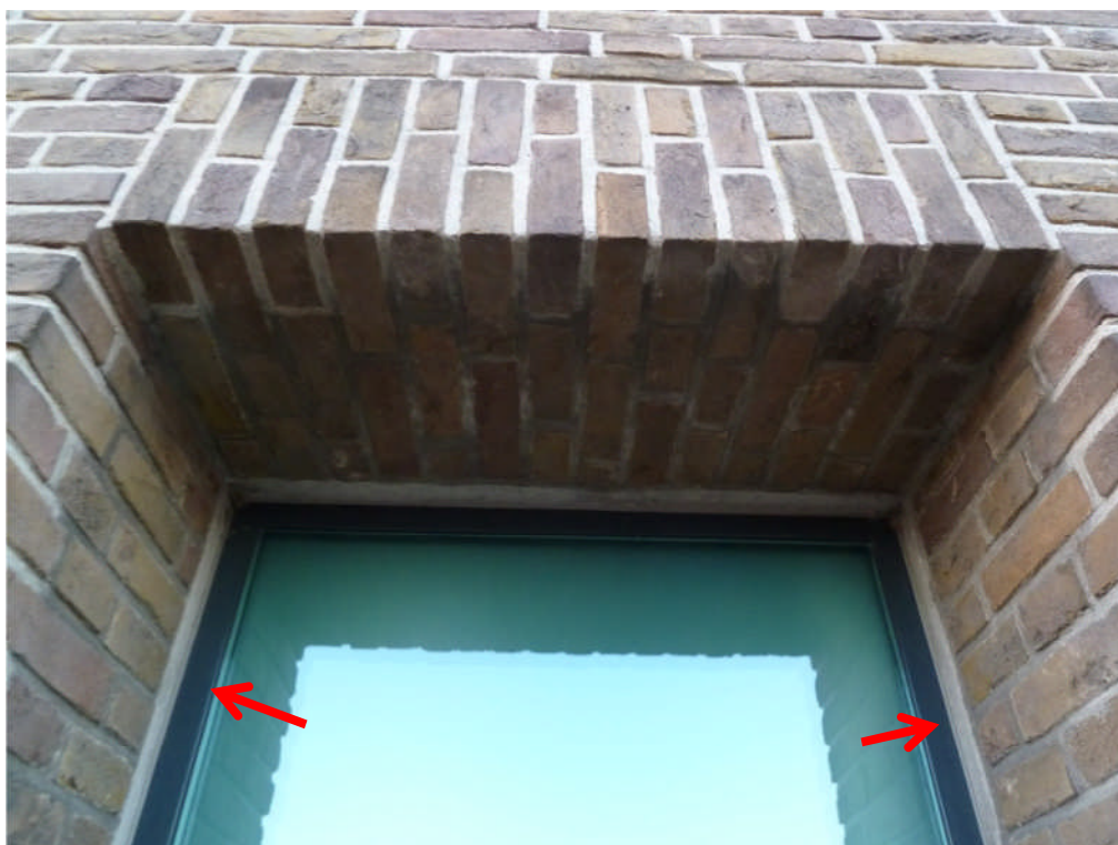
Foto 4.124: Zuidoostgevel (t.p.v. installatieruimte): De aansluiting van het kozijn op de gevel is niet aanvullend afgedicht met een kitband.
