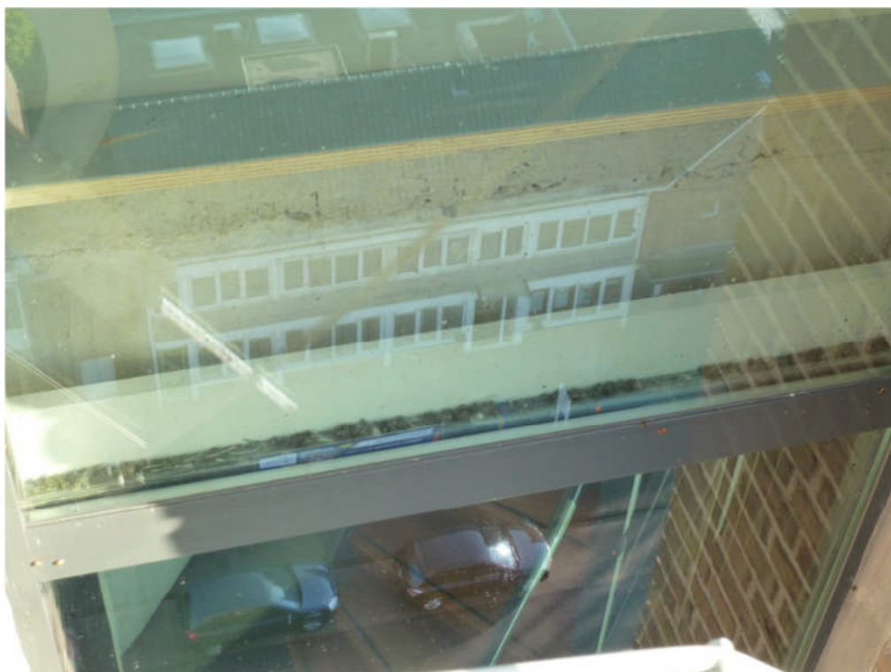
Foto 4.176: Westgevel: veel ongedierte (dode vliegen) ter plaatse van vloerranddetail (binnenzijde). Dit is niet te onderhouden (inherent aan vloerranddetail).
