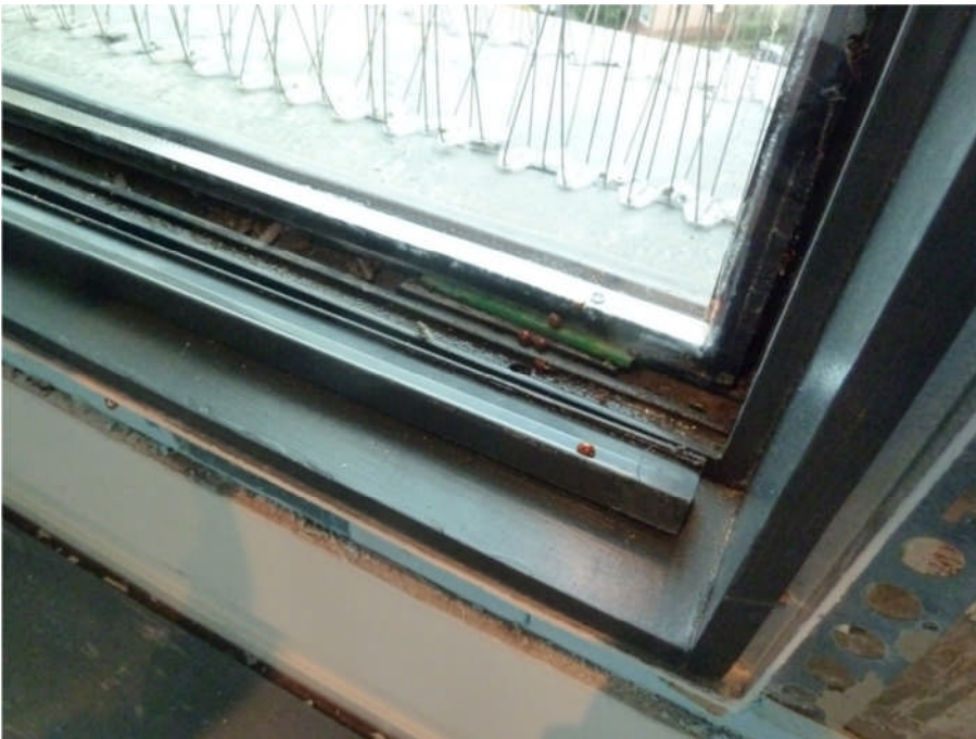
Foto 4.45: 7 e verd. – zeer veel vervuiling in de glassponning. Ontwatering kan zo niet afdoende plaatsvinden.
