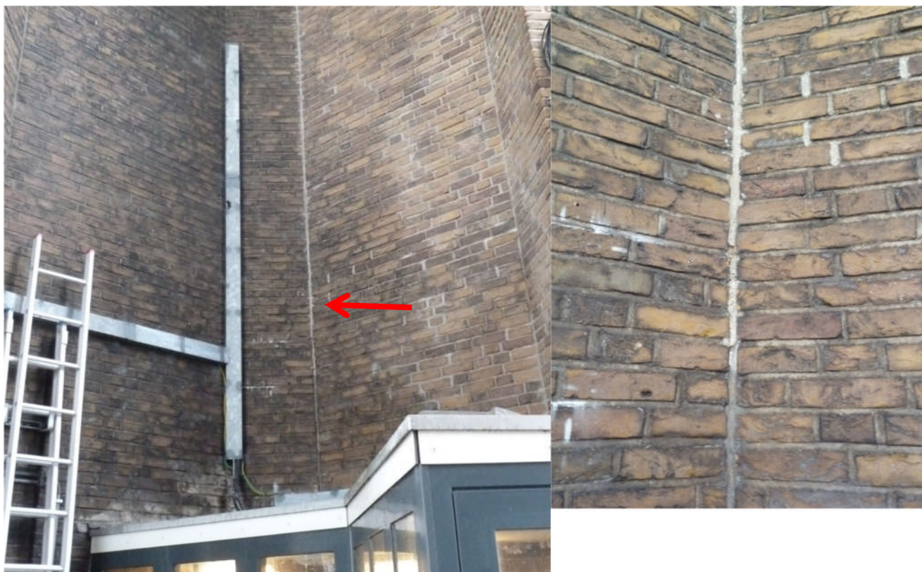
Foto 4.148a en -b: Sproeitest platform – plek waar is gesproeid op het dakje van de daktoegang op het platform. Zie voor de lekkage de volgende foto.
