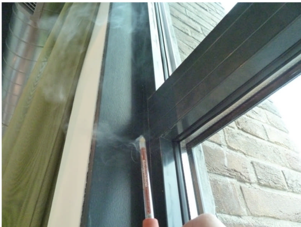
Foto 4.34: 7 e verdieping – luchtlekkages t.p.v. de stuiknaden van de glaslatten.
