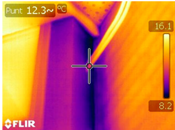
Foto 4.67n: Thermische lekken (vooral koudebrug) zijn zichtbaar. De constructie is hier niet geïsoleerd.
