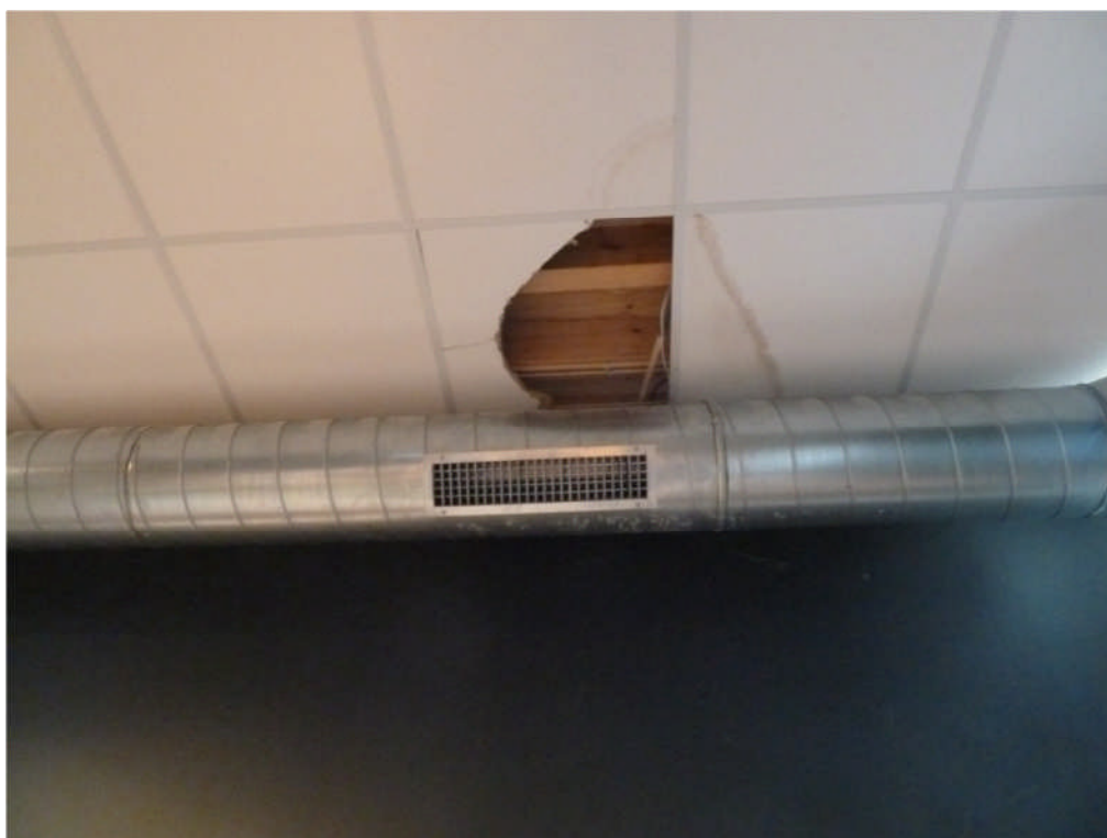
Foto 4.12: Leksporen op het plafond – verdieping onder 'omloopje'.
