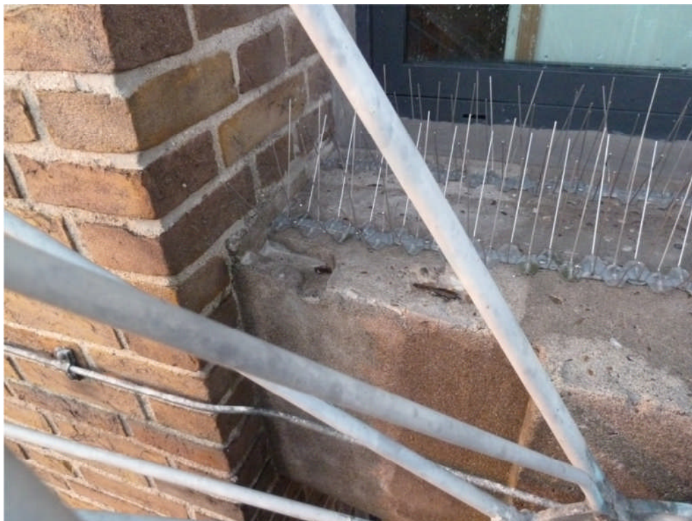
Foto 4.175: Zuidgevel ter plaatse van klok: betonrot (beperkte mate).
