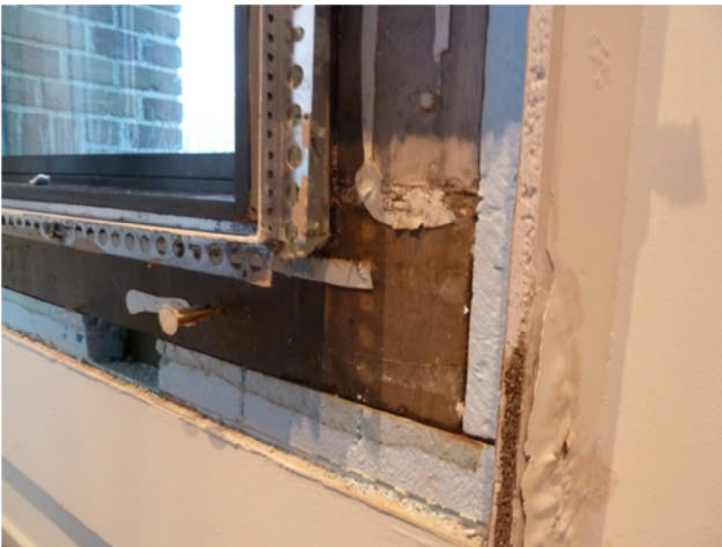
Foto 4.43: De betonnen kaders zijn afgewerkt met een XPS-isolatie. Dit is zorgvuldig gebeurd. Luchtdichtingen ontbreken echter. Ook een dampremmende laag ontbreekt hier, echter naar verwachting geeft dit slechts een beperkt risico op inwendige condensatie. Door luchtlekken is de kans op inwendige condensatie wel groot.
