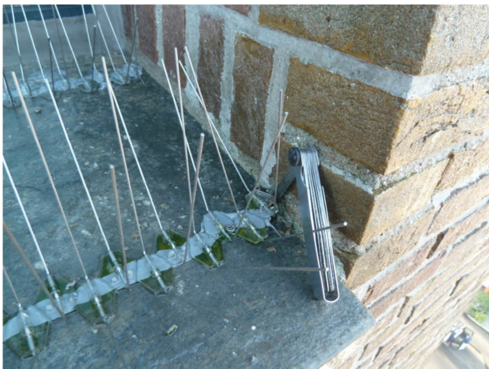
Foto 4.86: Noordgevel: kleine openingen tussen leistein afdekker en gevelmetselwerk. Komt op meerder plaatsen voor.
