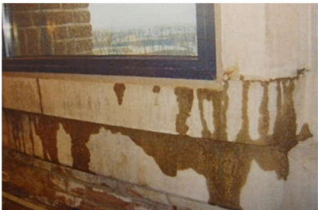
Foto 2.8: Lekkages 12-11-2010 – betonnen kaders en doorslag door gevel.
