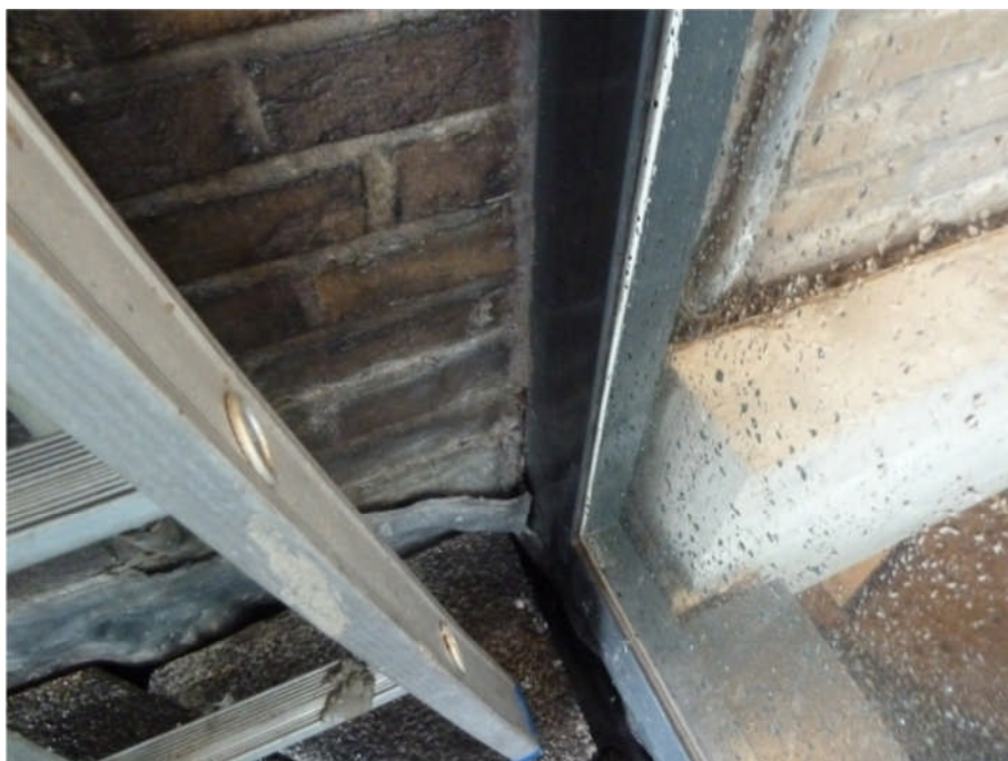
Foto 4.159: Visuele opname dak platform – lood hangt los en sluit niet waterdicht aan op het kozijn.
