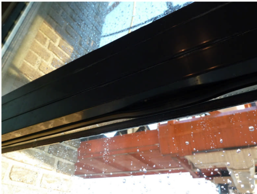
Foto 4.24: 7 e verdieping (overloop) – op enkele plaatsen komt het beglazingsrubber uit de glassponning.
