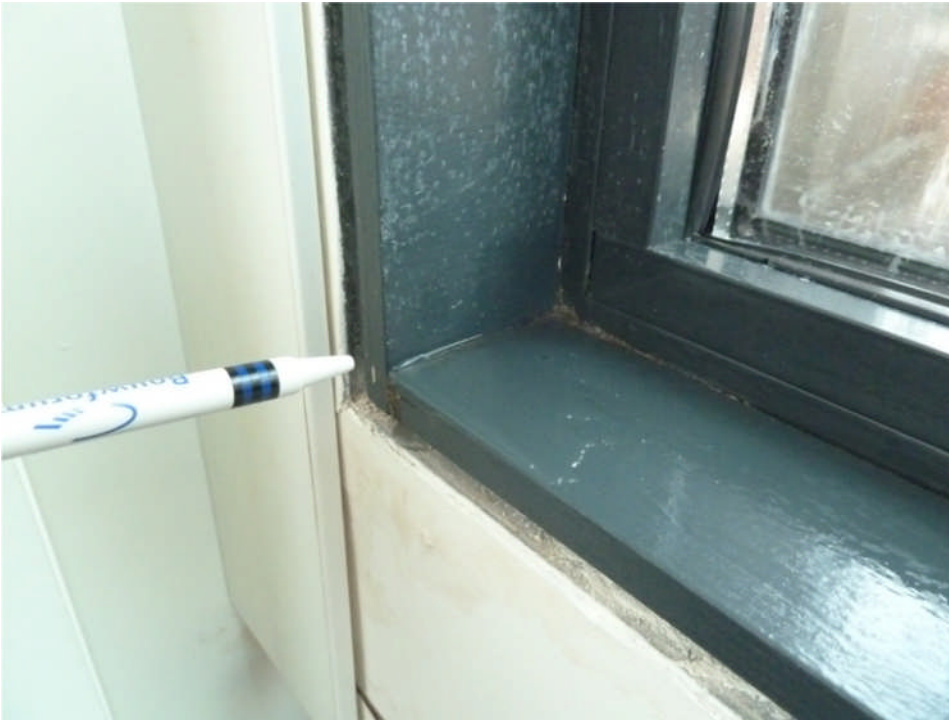
Foto 4.51: Sproeitest 7 e verdieping (restaurant) – lekkage binnen enkele minuten ter plaatse van de aftimmering (hoek) en ter plaatse van de stuiknaad van de glaslatten (ook niet vreemd omdat het beglazingsrubber aan de binnenzijde niet goed sluit).
