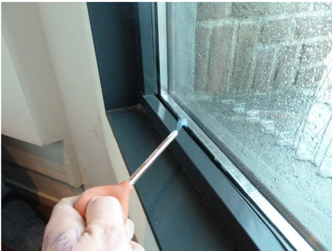
Foto 4.37: 7 e verdieping – de aansluiting van de glaslat op het glas is luchtlek. Ook niet vreemd omdat het beglazingsrubber hier niet goed zit.
