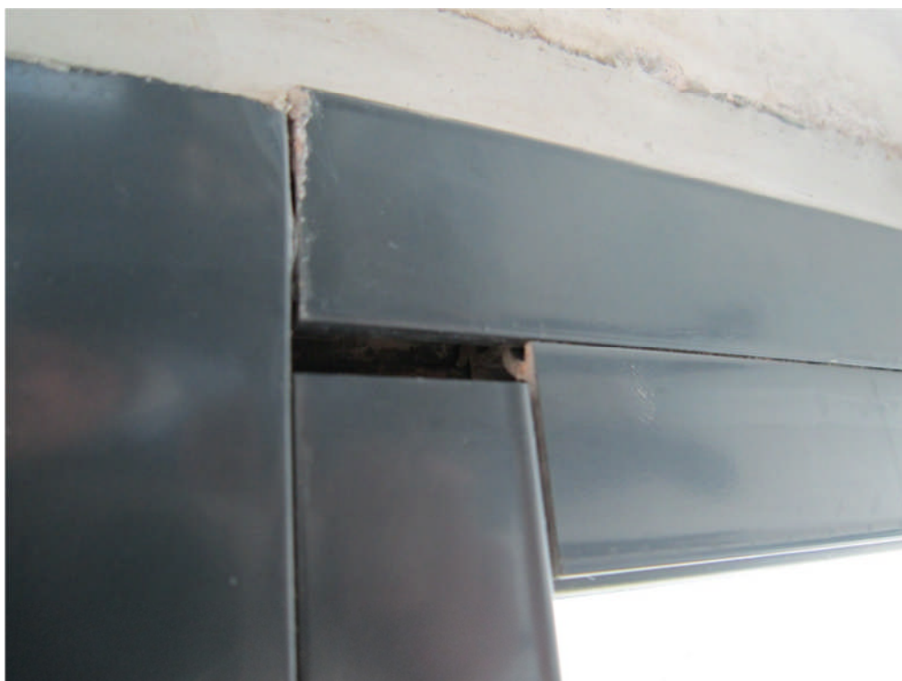
Foto 4.21: Op diverse plaatsen sluiten de glaslatten zeer slecht. Ook liggen de glaslatten niet altijd in één vlak.
