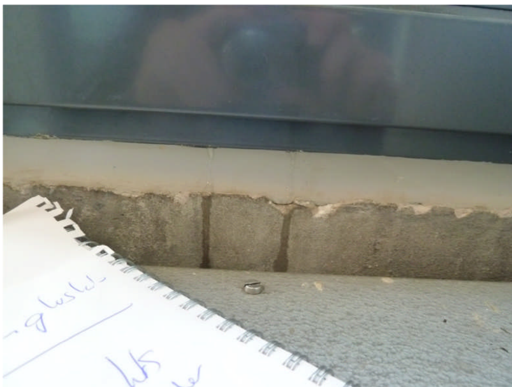
Figuur 4.59: Positie sproeitest 8 e verdieping (overloop, rechter raam) –lekkages ter plaatse van kitvoeg.
