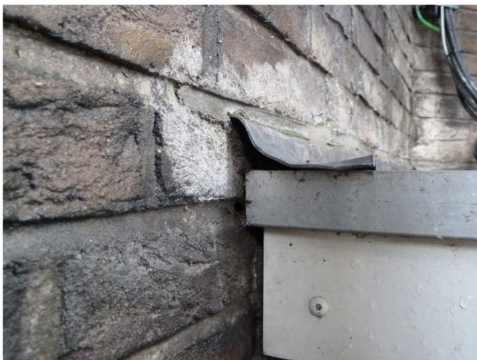
Foto 4.162: Visuele opname dak platform (dak van daktoegang) – aansluiting lood/dakrand/gevel is niet waterdicht.
