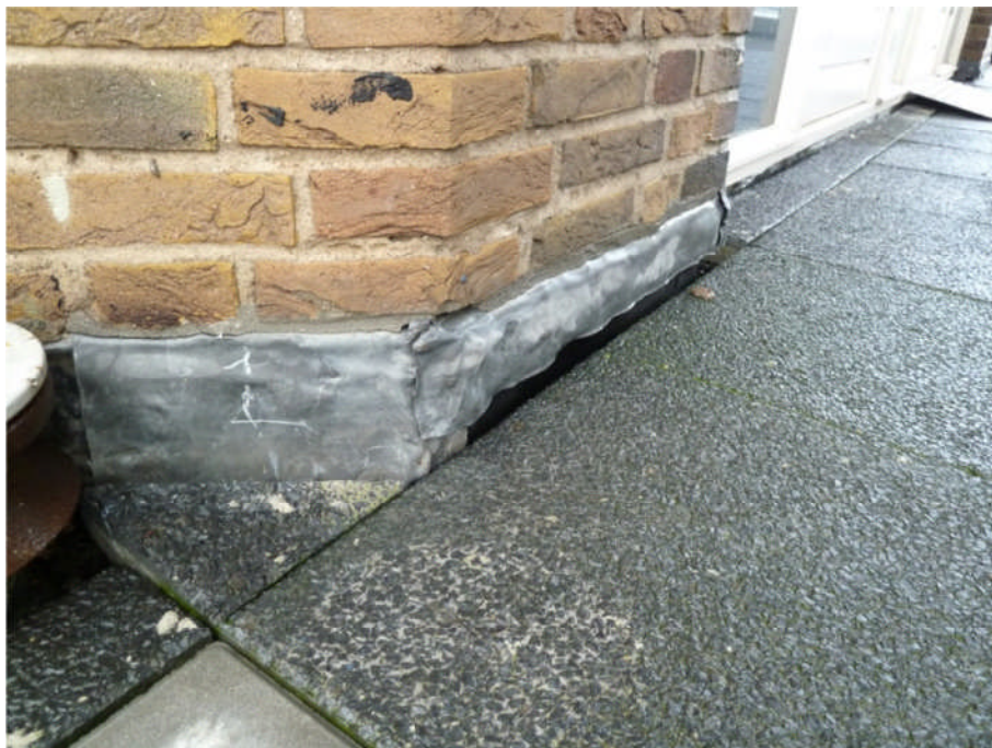
Foto 4.153: Visuele opname dak platform – lood is slordig aangebracht – niet goed aangeklopt. Voeg boven lood komt eruit.
