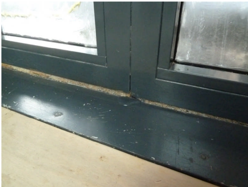
Foto 4.143: Sproeitest platform – binnen een minuut lekkage t.p.v. de aansluiting de gekoppelde kozijnen.
