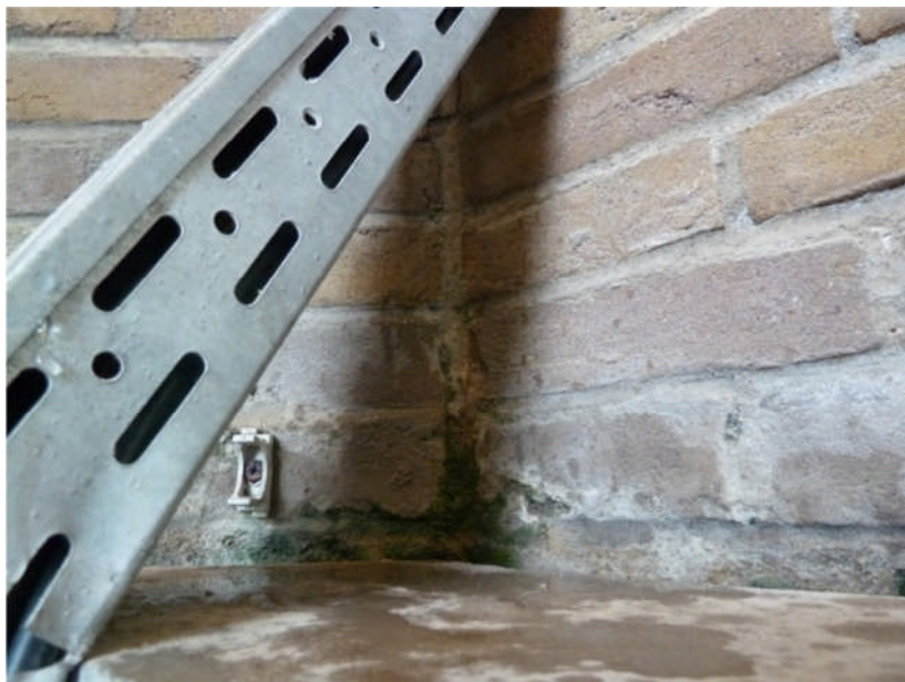
Foto 4.149: Sproeitest platform – tijdens het besproeien van het dakje van de daktoegang op het platform ontstaat aan de binnenzijde een lekkage. Zie voor de plek waar is gesproeid de vorige foto.
