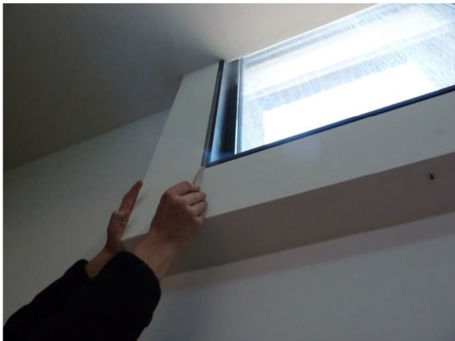
Foto 4.39: 10 e verdieping – luchtlekken ter plaatse van de hoeken van de vensterbank.
