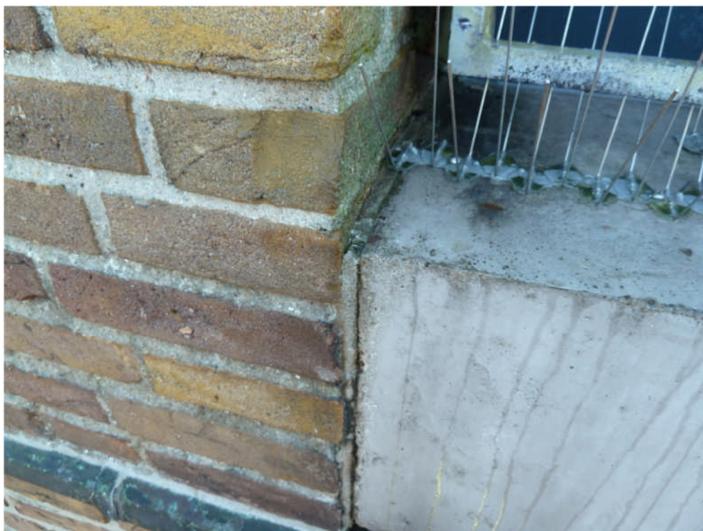
Foto 4.98: Noordgevel (boven de klok): voeg tussen betonnen rand en metselwerk is 'losgekrompen/onthecht'.
