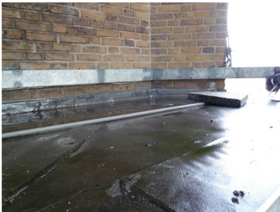
Foto 4.160: Visuele opname dak platform (dak van daktoegang) – lood hangt in water (dus capillair) en er staat een plas water (circa 20 mm) op het dak.
