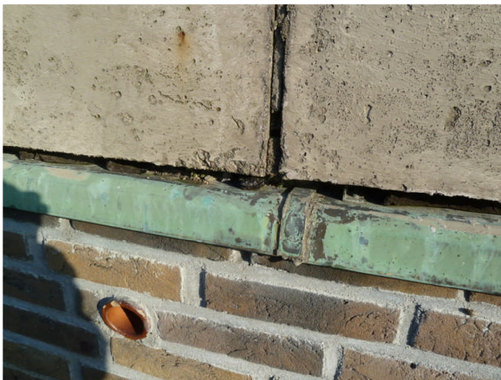
Foto 4.121: Westgevel dakrand t.p.v. platform – voeg tussen koperwerk en beton komt eruit zetten. Ook de voeg tussen de betonelementen komt los.
