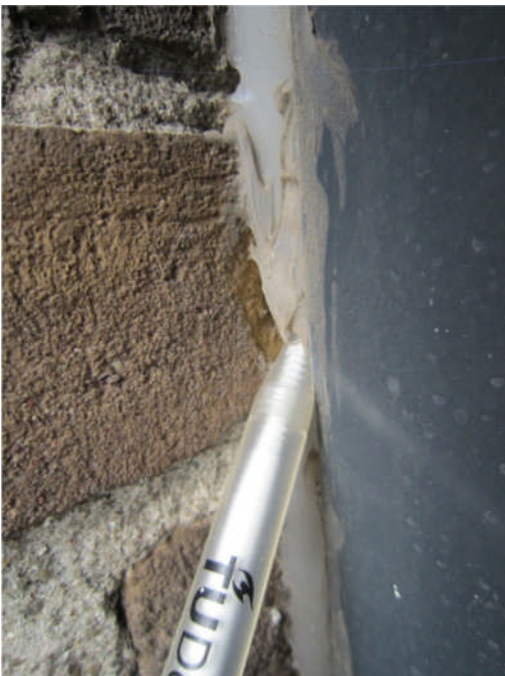
Foto 4.75: Ter hoogte van de begane grond zijn de aluminium kozijnen rondom met kit afgedicht. Niet overal hecht deze kit of er zijn onvolkomenheden aanwezig.
