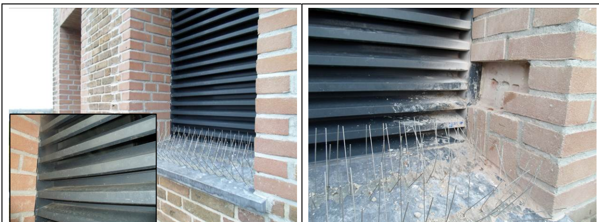
Foto 4.1 en 4.2: Water dringt door rooster en langs bouwkundige aansluitingen naar binnen
