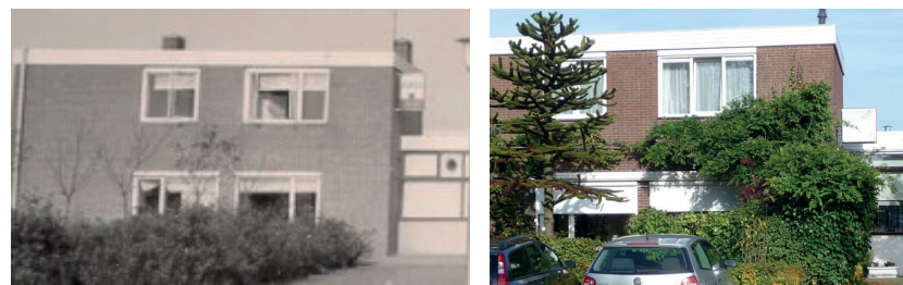
Detail van een historische opname waarop zichtbaar is dat de betonnen latei boven de vensters op de verdieping donkerder is dan de kozijnen. Op de afbeelding ernaast is de huidige situatie zichtbaar; de lateien zijn momenteel bij Zuiderwinkels 2 met de kozijnen wit geschilderd.
