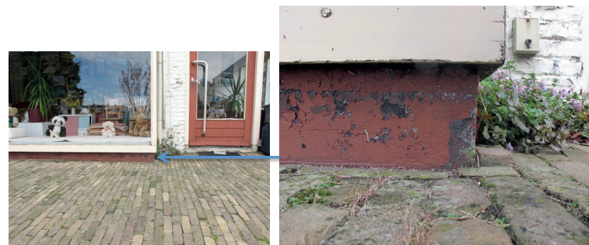
Borstwering onder de etalage van Ring 88. Onder de bruinrode, en bruine verlaag gaat een zwarte afwerking schuil. Daaronder bevindt zich waarschijnlijk de oorspronkelijke grijze afwerking.
