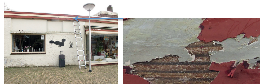
Locatie waar het boeiboord van Ring 88 werd onderzocht met daarnaast de sondering waar de grijze laag goed zichtbaar is en slechts een klein stukje van de crèmekleurige afwerking eronder.
