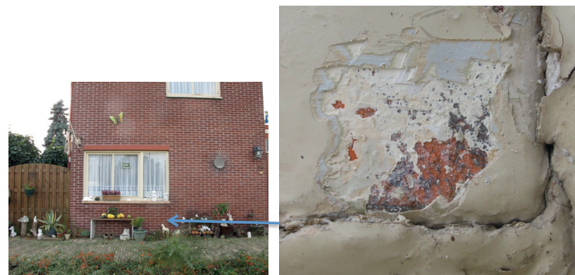
Stalen vensterkozijn woning Ring 88 met een sondering van de opeenvolgende afwerklagen. Op het staal is een oranje menielaag aangebracht gevolgd door een lichte crèmekleurige afwerking en een lichtgrijze.
