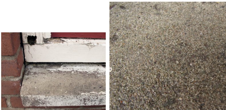
Een van de waterdorpels met resten van verschillende lagen verf en daarnaast een detail van de fijne kiezellaag die er op aan is gebracht.
